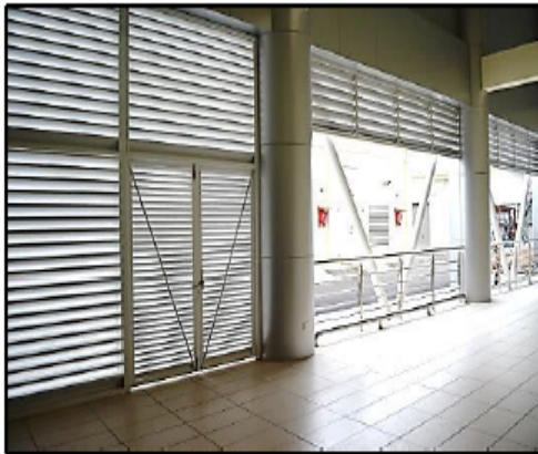
Bangunan Terminal - Reka Bentuk Yang Tidak Memenuhi Aspek Keselamatan (29.03.2017)
