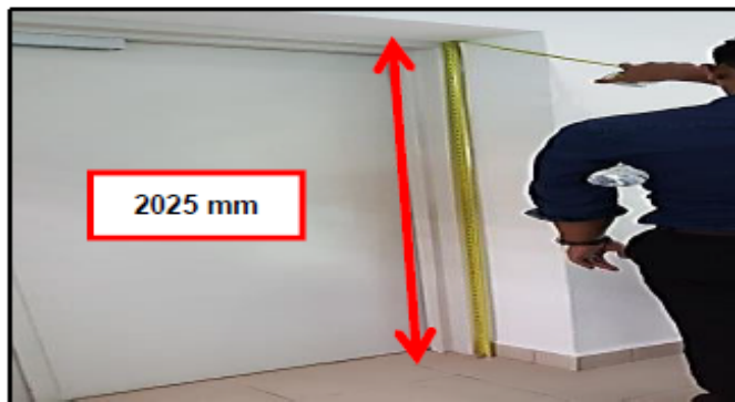
Bangunan CIQ - Ketinggian Pintu Yang Dibina 2025mm Tidak Mengikut Spesifikasi iaitu 2100mm (14.11.2016)
