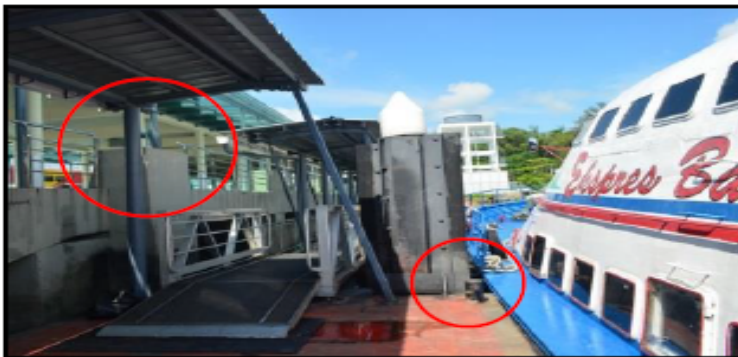
Jeti Kuah, Langkawi, Kedah - Kedudukan Bollard Di Jeti Dan Pontoon (5.9.2017)
