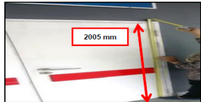
Bangunan CIQ - Ketinggian Pintu Yang Dibina 2005mm Tidak Mengikut Spesifikasi iaitu 2100mm (15.11.2016)
