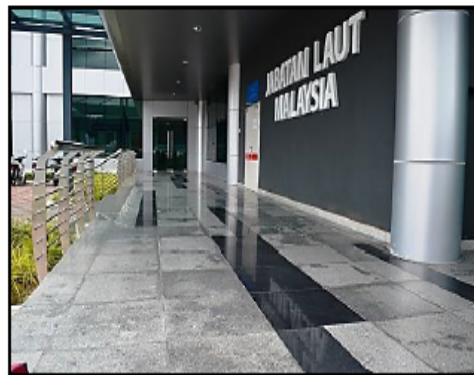
Kawasan Luar - Permukaan Lantai Granite Yang Mempunyai Kesan Tompokan Dan Watermark (29.03.2017)
