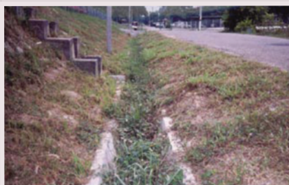
Longkang ditumbuhi rumput.
