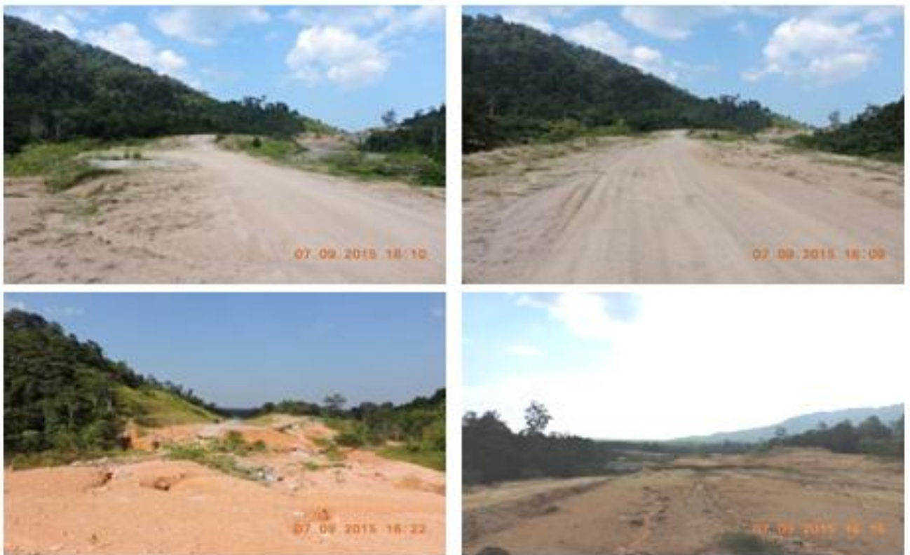
Gambar seksyen jalan yang belum disiapkan kerana kegagalan pembentung yang mengalami keretakan (pembentung C1, C2 dan C3) dan perubahan rekabentuk (pembentung C4, C5 dan C6)
