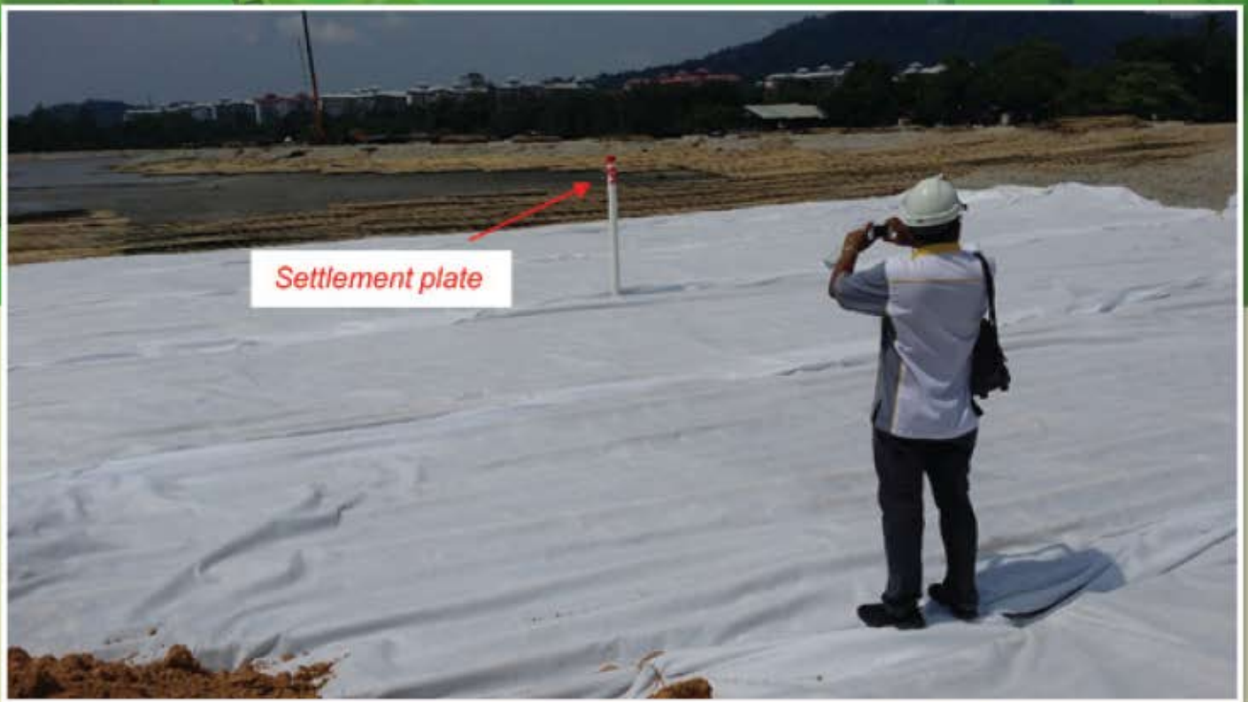
Gambar 2 : Settlement plate yang digunakan untuk memantau tahap pemendapan tanah
