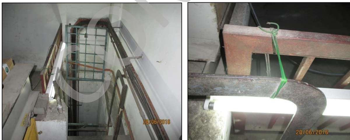
Gambar 2 – Mild steel grills dan tangga laluan ke bilik LMR dalam keadaan usang dan boleh membahayakan kakitangan penyenggaraan.
