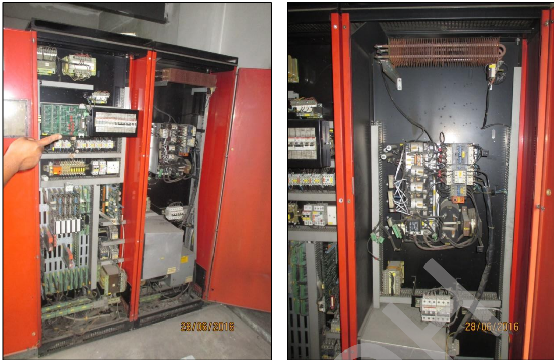
Gambar 7 – Lift controller L2-A dan L1-B didapati tidak berfungsi sejak 2014 akibat terkena air hujan memasuki bilik melalui pintu sisi bilik LMR dan mengakibatkan peralatan tersebut rosak.
