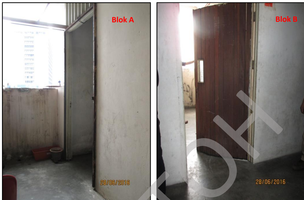
Gambar 1 – Pintu masuk bilik LMR tidak berkunci dan tiada papan tanda amaran diletakkan.
