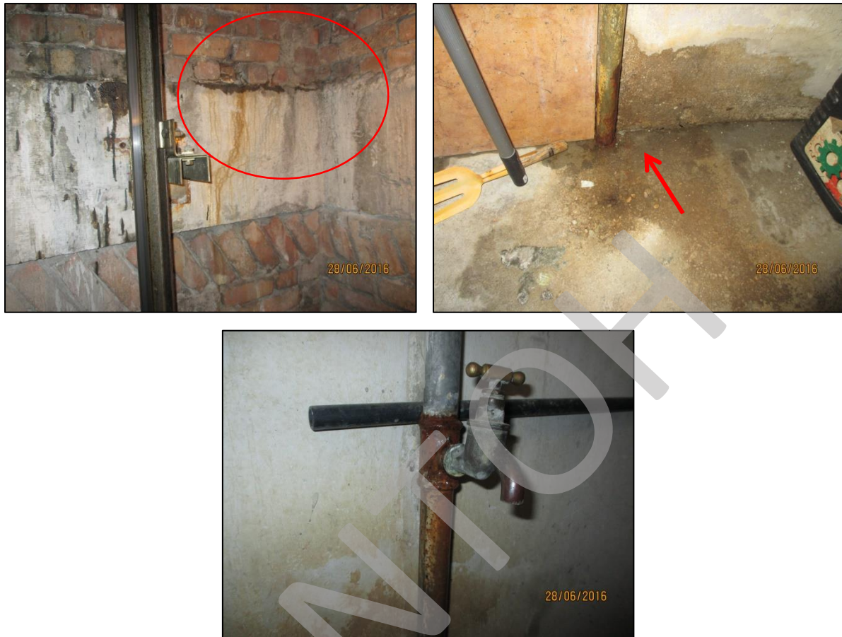
Gambar 13 – Air dari paip air di dalam bilik sampah di Aras 7, Blok B meresap melalui dinding dan memasuki lift shaft .
