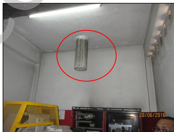
Gambar 14 – Terdapat paip yang tidak dapat dikenalpasti fungsinya pada bahagian atas peralatan lift controller . (L1-B).
