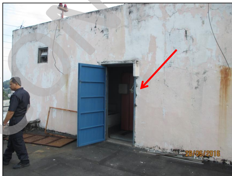
Gambar 4 –Pandangan dari luar bilik LMR melalui pintu sisi tersebut. Anak panah – kedudukan lift controller .
