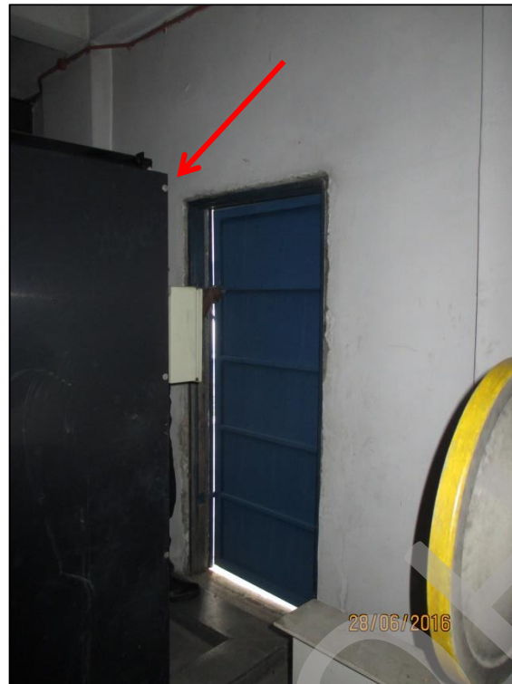
Gambar 3 –Air hujan didapati masuk ke bilik LMR melalui ruang ( gap ) pintu sisi tersebut. Anak panah – Kedudukan lift controller berdekatan dengan pintu sisi tersebut.
