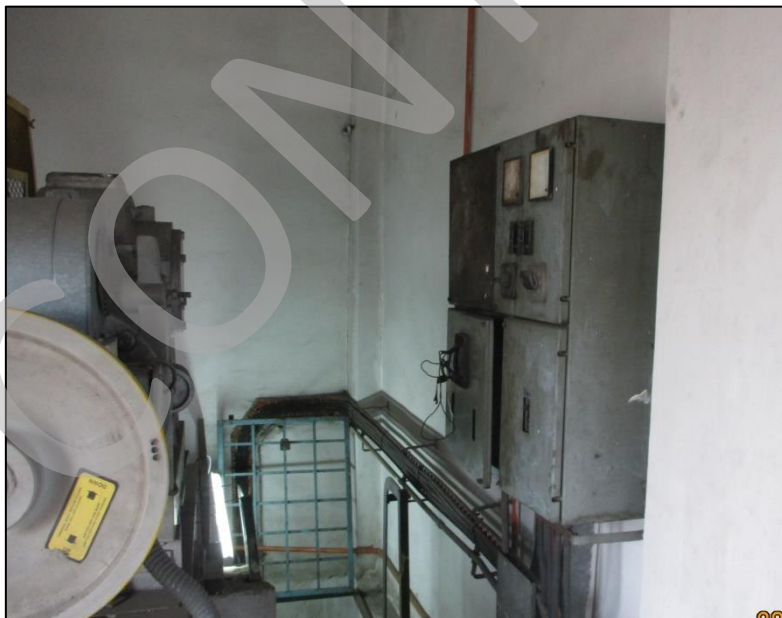
Gambar 8 – Switchboard peralatan lif telah usang dan dicadangkan untuk dinaiktaraf.
