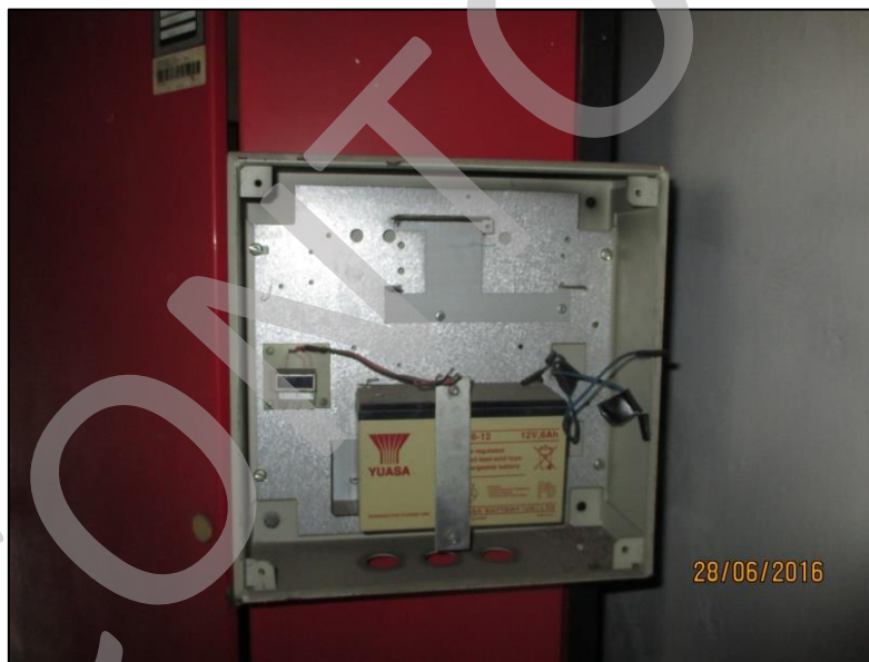
Gambar 6 – Emergency Battery Power Supply (EBOPS) untuk alarm bell tidak berfungsi. Power supply bagi alarm bell sedia ada berkongsi dengan car top lighting .
