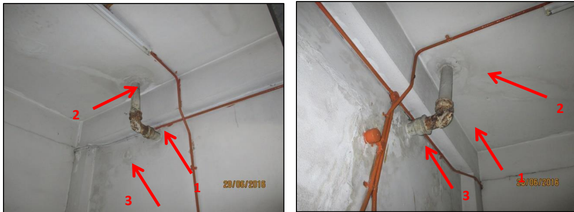
Gambar 9 – Rain water down pipe melalui bilik LMR (Anak panah 1). Juga terdapat kesan resapan air pada bahagian dinding dan roof slab (Anak panah 2 & 3)
