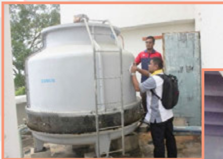
Pemeriksaan Cooling Tower
