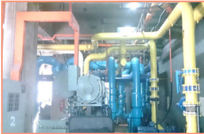
Keadaan Chiller Plant Room Sedia Ada Yang Tidak Tersusun Dan Menyukarkan Kerja-Kerja Penyelenggaraan
