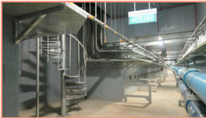
Terowong Servis Yang Menempatkan Kesemua Paip Dan Kabel Sistem Mekanikal Dan Elektrikal Yang Menghubung Antara Blok Mekanikal Dengan Blok Utama Parlimen
