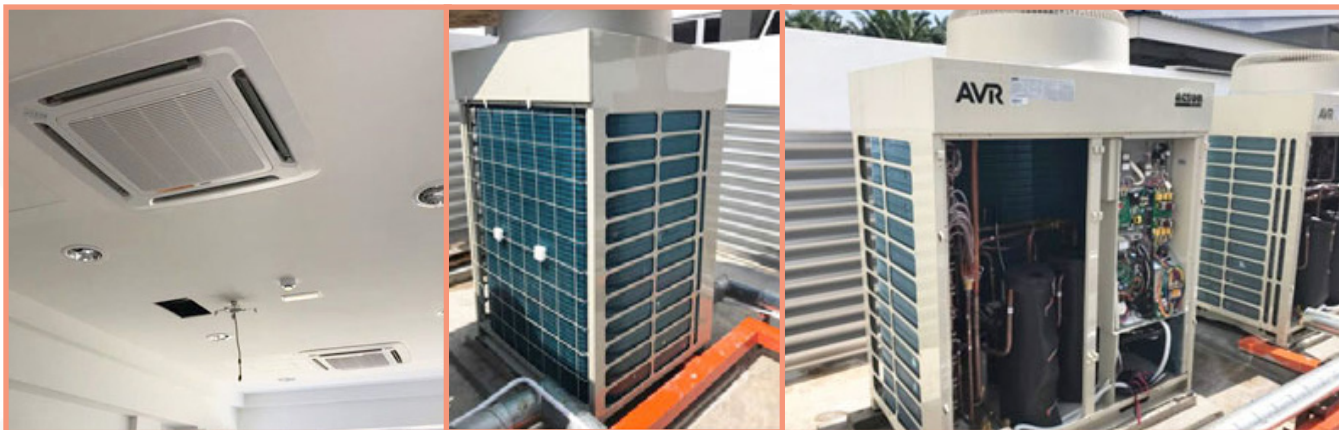
Sistem Penyejukan Udara Jenis VRF Membenarkan Kawalan Dibuat Secara Individu Bagi Setiap Bilik
