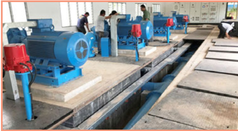
Kedudukan Pam, Trenches Dan Panel VFD Di Dalam Rumah Pam
