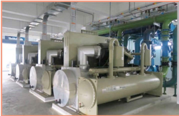
Sistem Penyejukan Udara Jenis Water Cold Chiller
