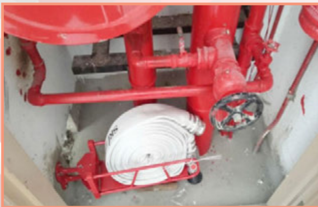
Landing Valve, Hose Cradle Dan Hose Untuk Sistem Wet Riser Bagi Setiap Tingkat Kediaman Kuarters Perumahan
