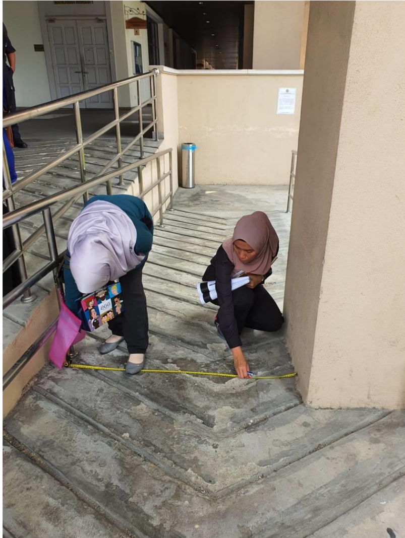
Ramp yang tidak mengikut spesifikasi
