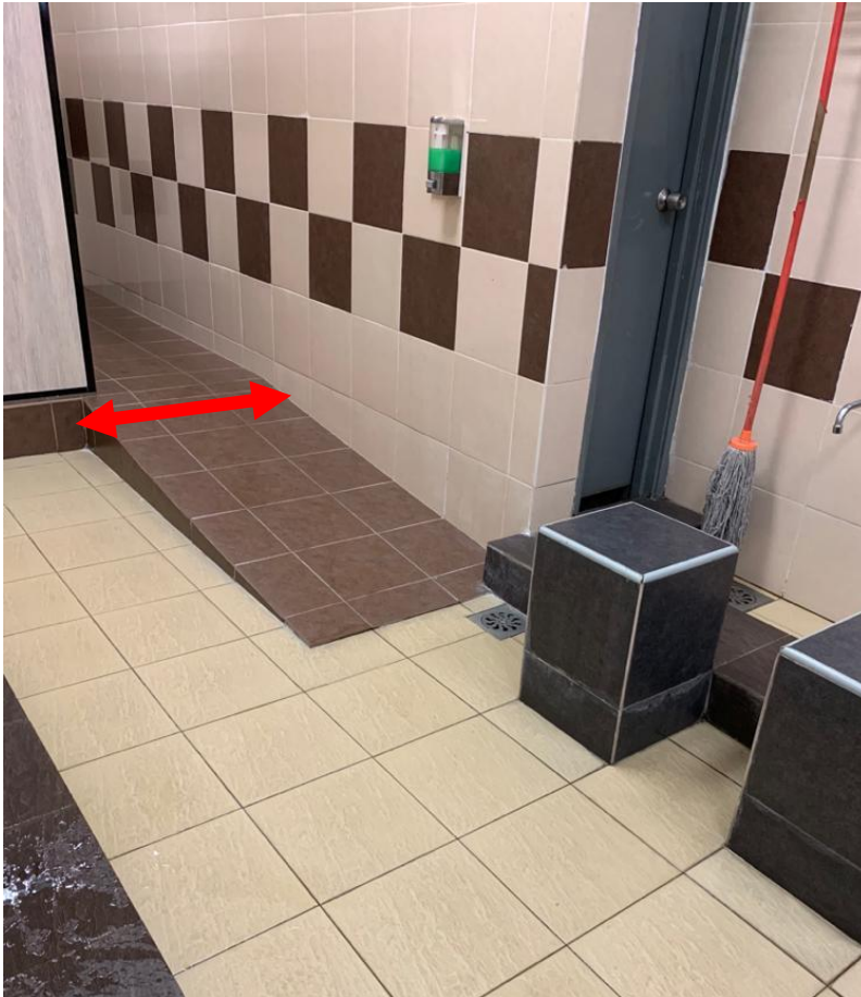
Ramp yang sempit dan tidak menepati spesifikasi di ruang wuduk
