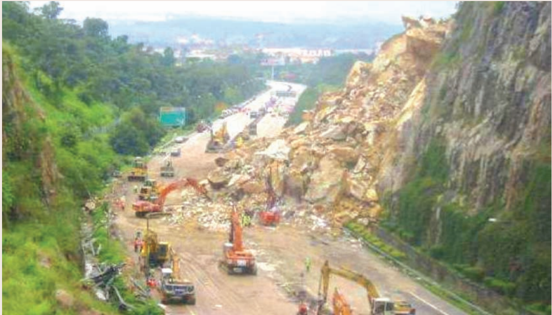
Rajah 2.6: Runtuhan batu di Km 21.8 Lebuh raya Klang Utara
