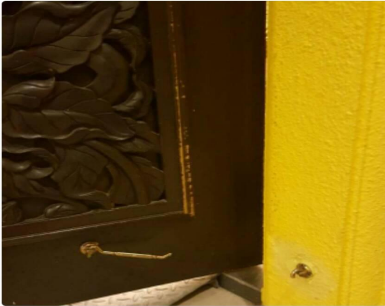
Penyangkut pintu patah pintu utama dewan mph
