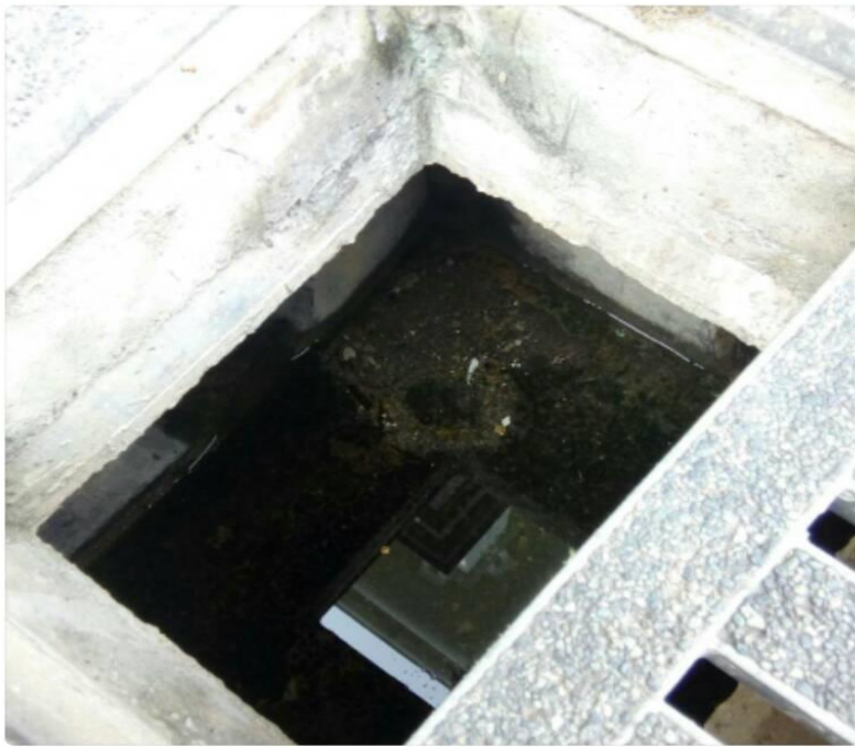
Mendapan pasir dlm sump dan air dlm pipe culvert. Possible some blockage. Depan Pejabat trafik
