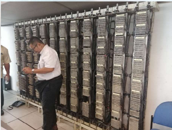
Subscriber Distribution Frame (SDF) yang masih menggunakan kabel jenis Multipair (Copper Cable) untuk sistem telefon
