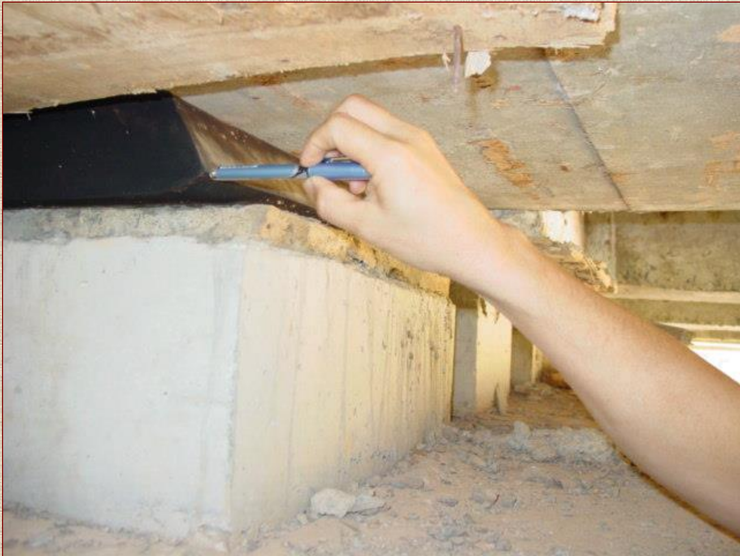
Abutment senget semasa pembinaan
