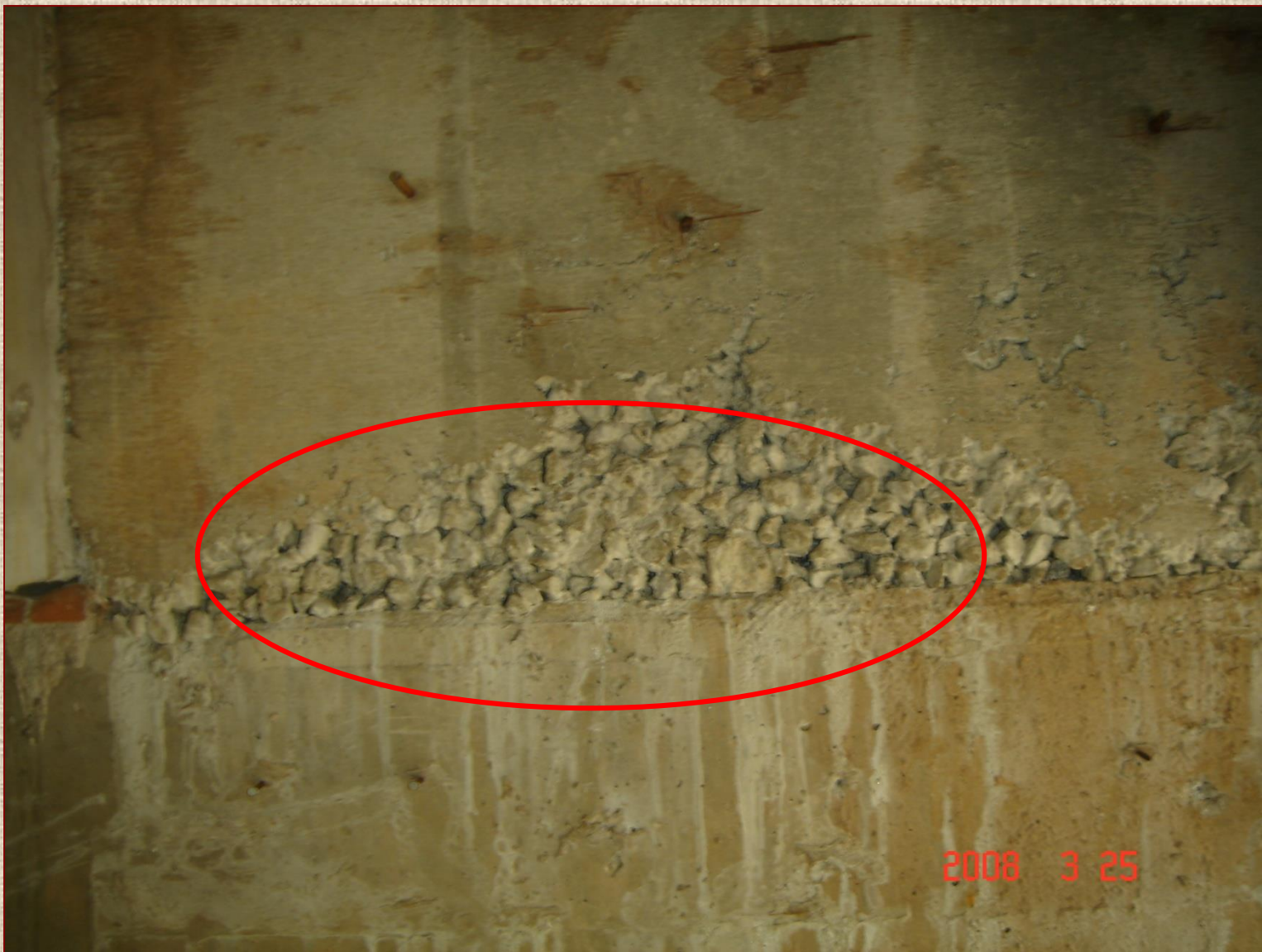
Honeycomb pada sambungan ( abutment )
