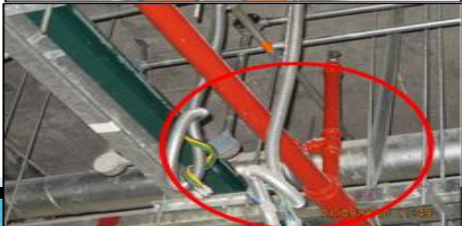
Paip Sprinkler Berada Di Atas Laluan Elektrik
