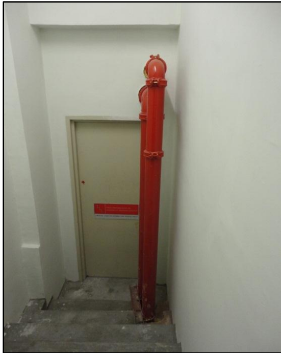
Paip fire fighting dipasang di atas tangga
