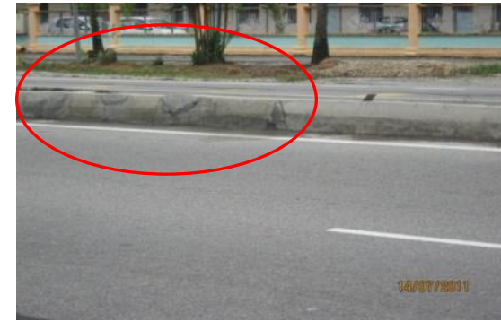
Pembinaan Kerb Yang Tidak Berkualiti
