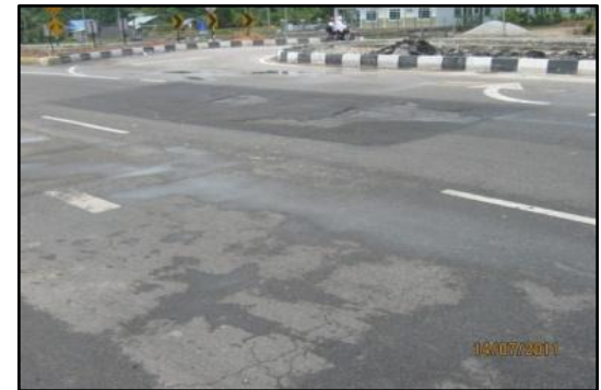
Kerja-kerja Premix Yang Dibuat Pada Waktu Hujan Dan Tidak Mengikut Spesifikasi
