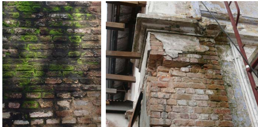
Gambar 3.1: Contoh kecacatan bangunan warisan pada bahagian dinding; permukaan dinding berlumut (gambar kiri), pelepa dinding terkopek, ikatan bata longggar dan bata tanggal (gambar kanan)
