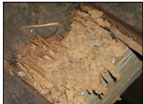
Gambar 4.6: Kerosakan kayu akibat dimakan anai- anai
