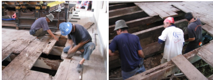
Gambar 4.7: Kecacatan utama pada lantai adalah pereputan kayu akibat serangan anai-anai. Gambar kiri dan kanan; kerja-kerja mengeluarkan papan lantai dan gelegar lantai yang rosak
