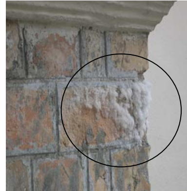
Gambar 4.5: Penggaraman pada permukaan diinding
