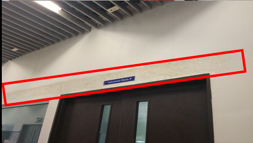
Kesan kulat di column dan lintel
