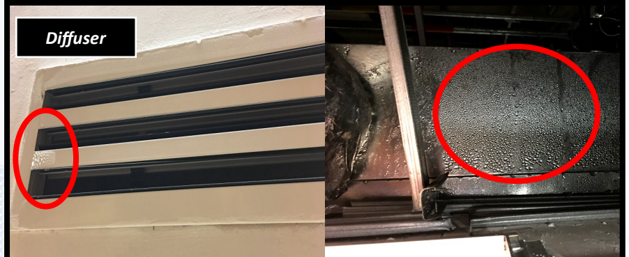
Kondensasi pada diffuser dan plenum box
