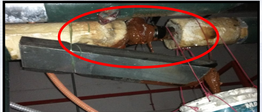
Kebocoran pada chilled water pipe yang tidak dibaiki
