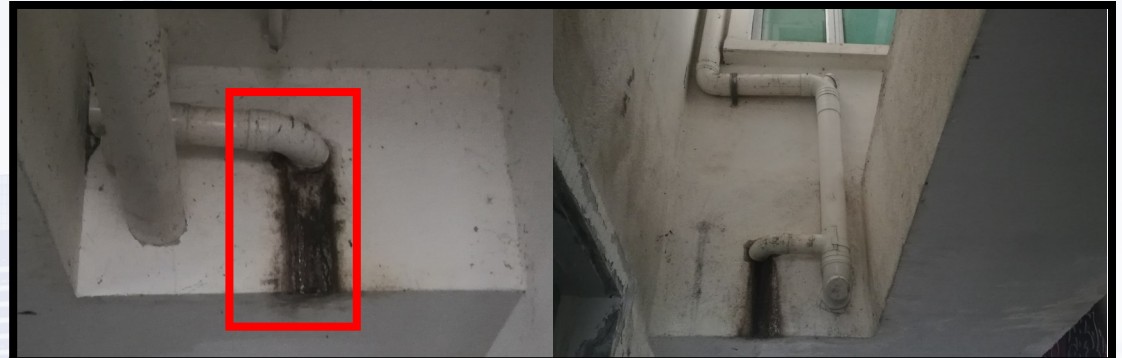
Kebocoran pada paip sanitari
