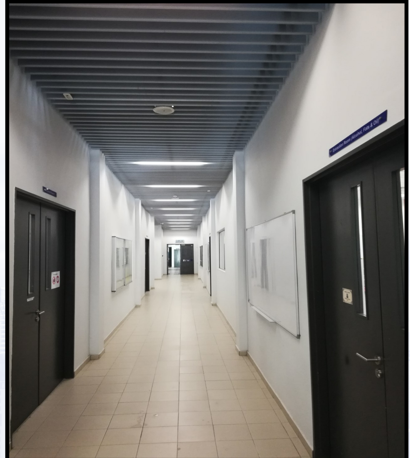
Ruang koridor yang tertutup dan tiada pengudaraan
