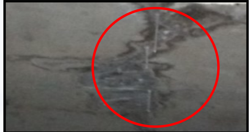
Kesan kebocoran pada slab
