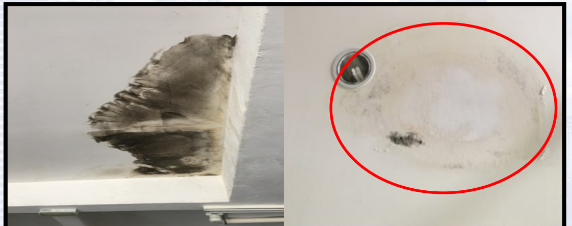
Kesan kebocoran pada siling
