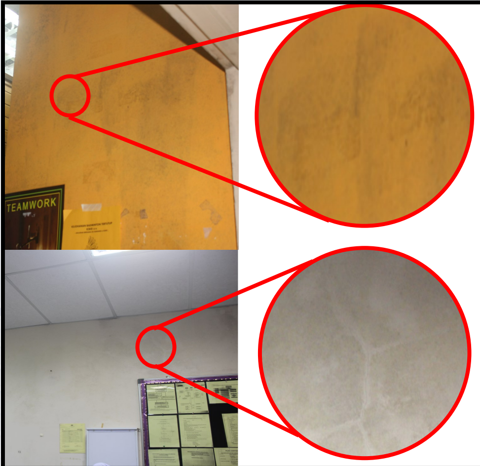
Kulat di permukaan dinding
