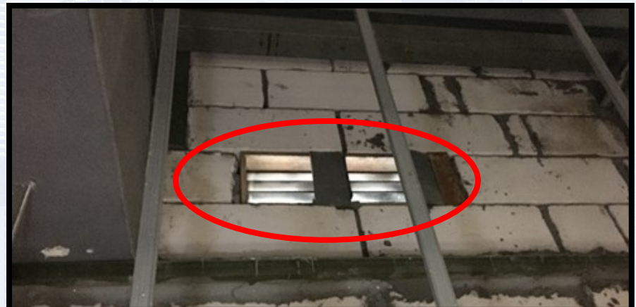
Infiltrasi udara luar ke ruangan siling
