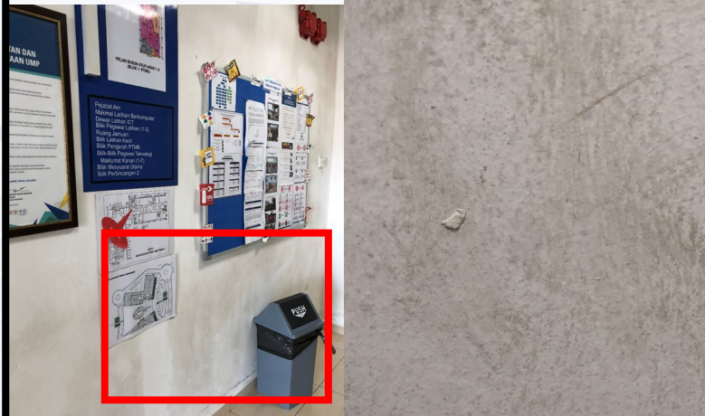
Kesan kulat di permukaan dinding
