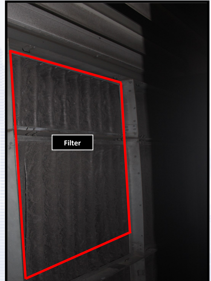
Filter pada unit AHU tidak disenggara
