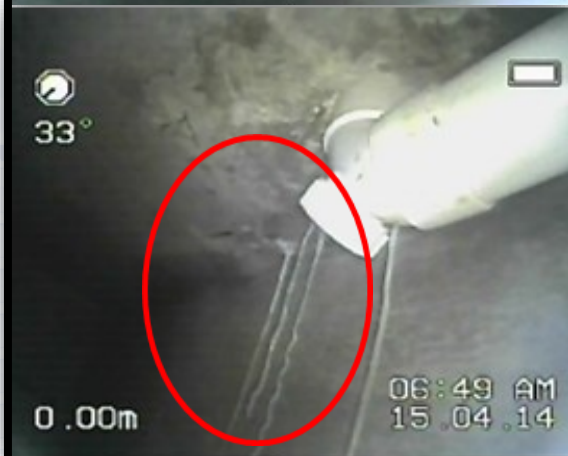
Kebocoran pada slab
