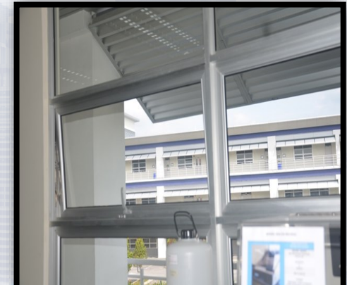
Operasi makmal - tingkap yang sentiasa terbuka mengakibatkan infiltrasi udara luar ke dalam bilik
