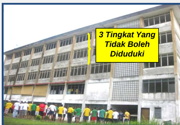
Blok Asrama, PUSPEN Benta - Tiga Tingkat Asrama Penghuni Usang Dan Tidak Selamat Diduduki
