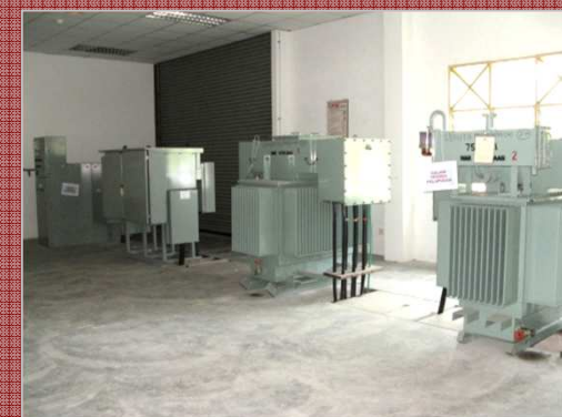
ILP Kota Samarahan Step Down Power Transformer 1 & 2 Harga Perolehan : RM84,665
