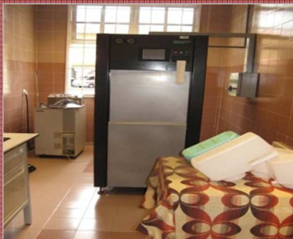
Makmal Patologi - Autoclave (Laboratory Steam Sterilizer) Tidak Boleh Digunakan Kerana Rosak Sejak Dibekalkan
