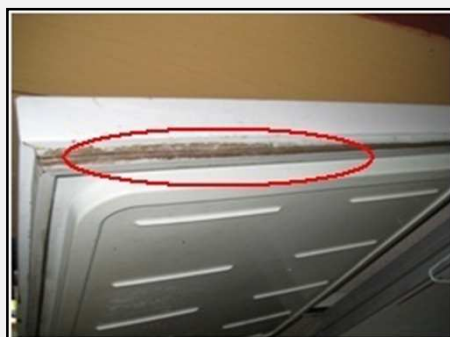
Keadaan Dalaman Peti Sejuk Yang Tidak Digunakan Dan Berkulat Di Balai Raya Kampung Bukit Samsu, Kota Tinggi Johor
