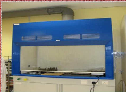
Makmal Patologi - Fume Cabinet Tidak Boleh Digunakan Kerana Tidak Diuji
