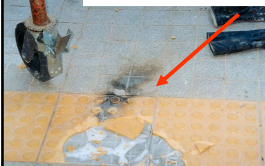
Kelihatan kesan arka melalui scaffolding hingga ke lantai
