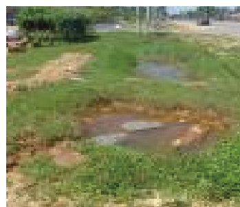
Earth drain tidak disenggara dengan sempurna.
