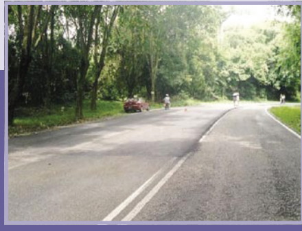
Pengikisan permukaan jalan di lorong sebelah kanan jalan.
