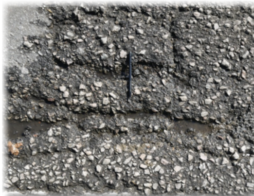
Permukaan jalan yang basah selepas hujan dan air meresap masuk ke lapisan bawah melalui keretakan.
