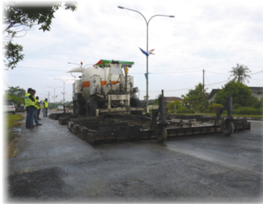
HIPR dilakukan selepas hujan/ke atas permukaan jalan yang basah dan mengalami keretakan.
