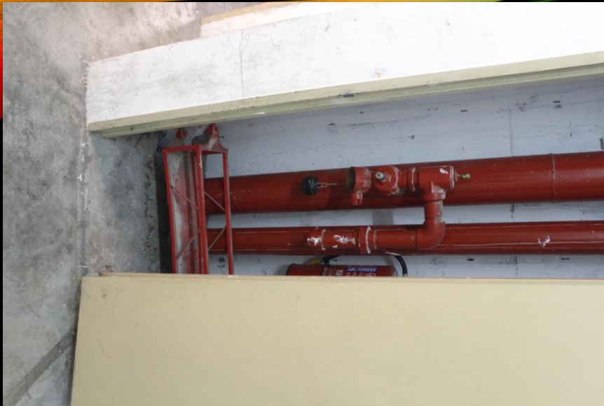
HOS TIDAK DISEDIAKAN UNTUK SISTEM 'WET RISER'
