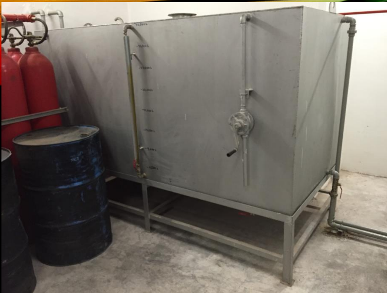
TIDAK MENYEDIKAN 'BUND WALL' PADA TANGKI SIMPANAN DIESEL
