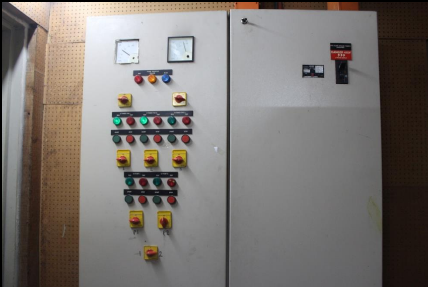
SISTEM AHU TIDAK DAPAT DIMATIKAN SECARA AUTOMATIK APABILA PENGGERA
