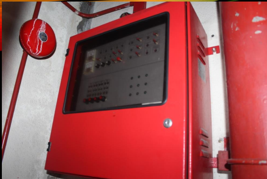
PANEL PENGGERA KEBAKARAN TIDAK DAPAT BERFUNGSI
