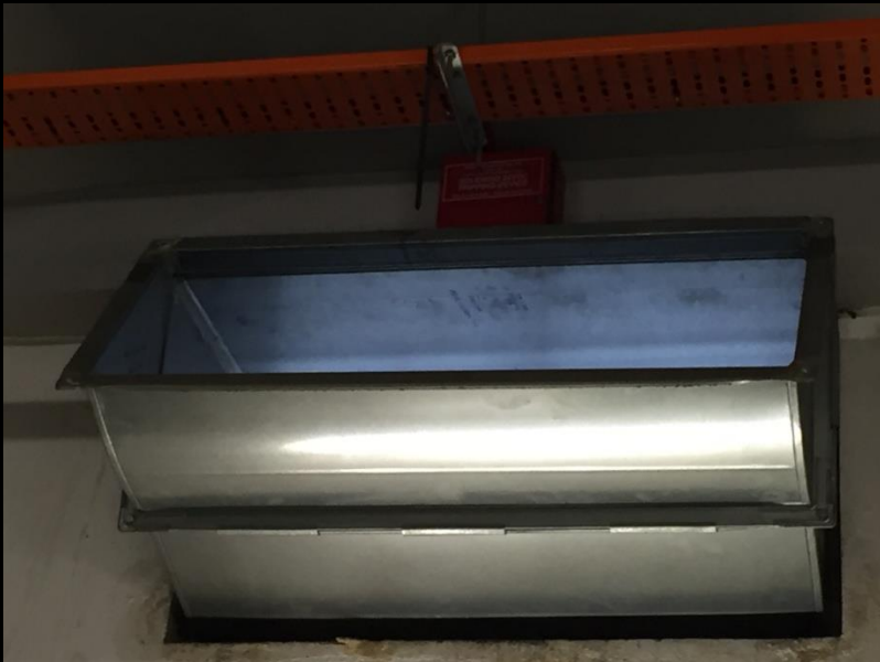
'FIRE CURTAIN' DITANGGALKAN PADA BUKAAN DI BILIK GENSET
