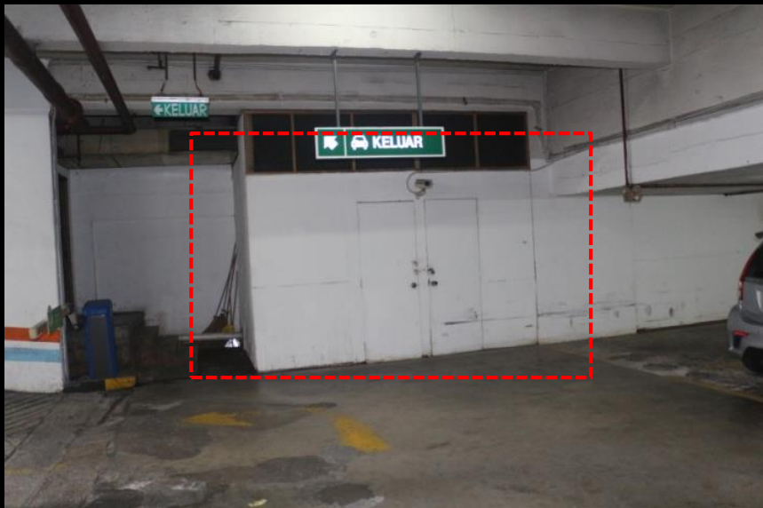
Pembinaan stor pada tempat letak kereta tanpa mendapat kelulusan dari pihak berkuasa
