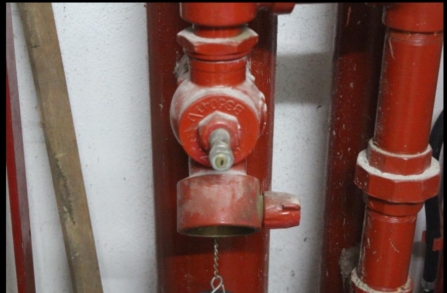
TIADA HAND WHEEL PADA 'LANDING VALVE' SISTEM 'WET RISER'
