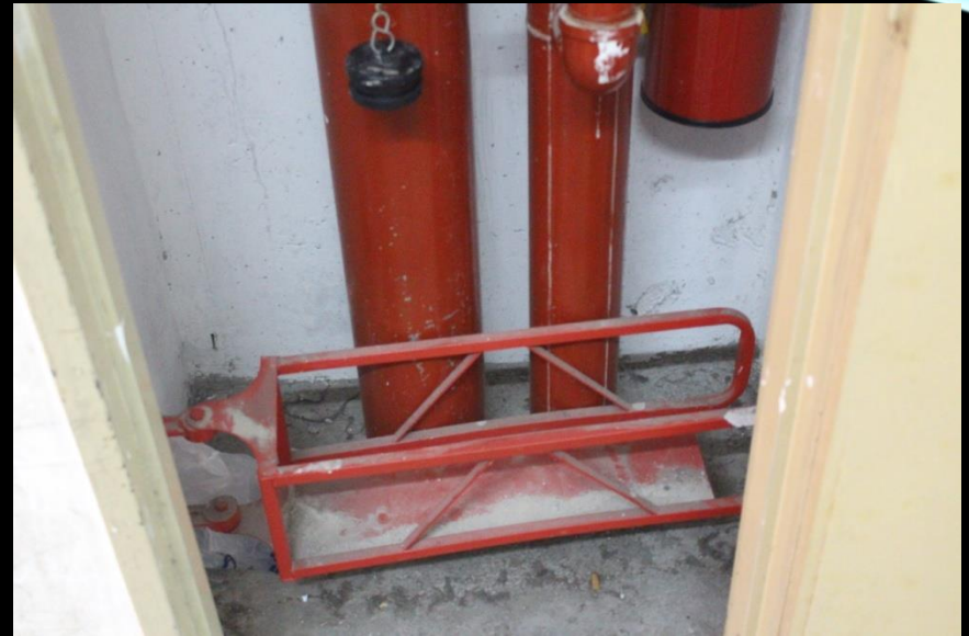
HOS TIDAK DISEDIAKAN UNTUK SISTEM 'WET RISER'
