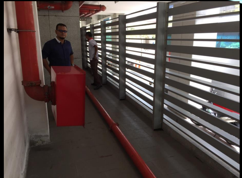
PAGAR PENGHALANG YANG DI PASANG DI HADAPAN 'INLET VALVE' SISTEM SPRINKLER
