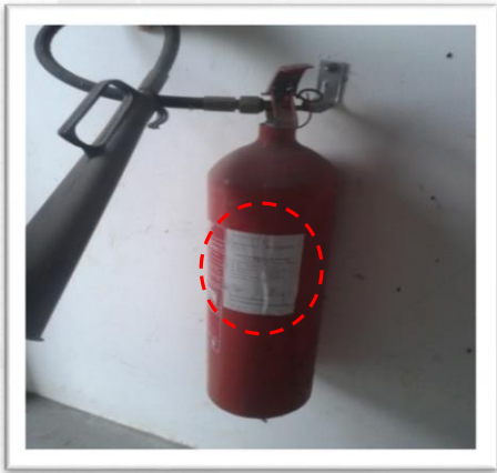
Alat pemadam api telah tamat tempoh dan tidak diperbaharui.
