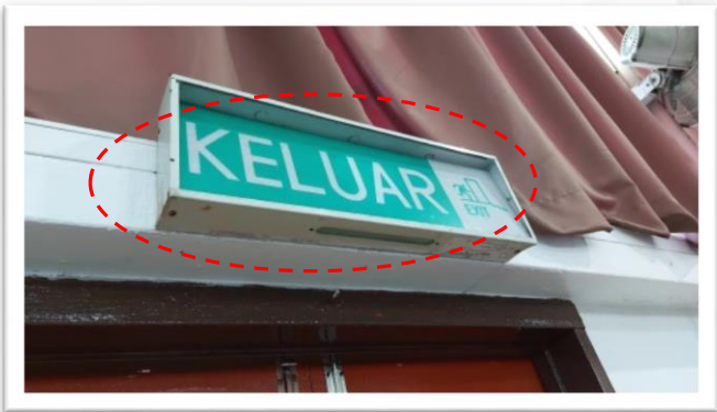
Tanda tempat keluar kecemasan tidak berfungsi.
