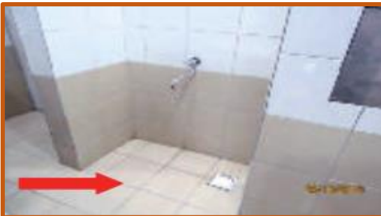
Tempat mengambil wuduk tidak mempunyai bebendul dan ini boleh menyebabkan air mengalir di kawasan berhampiran
