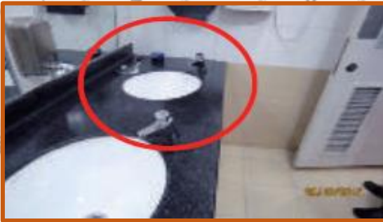
Kedudukan pili air yang tidak sesuai
