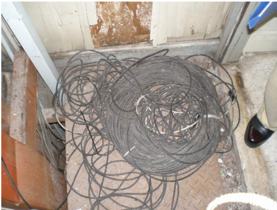
No 6 : Tempat riser yang tidak kemas
