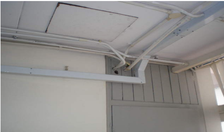
No 2 : Keadaan pendawaian yang tidak kemas/teratur
