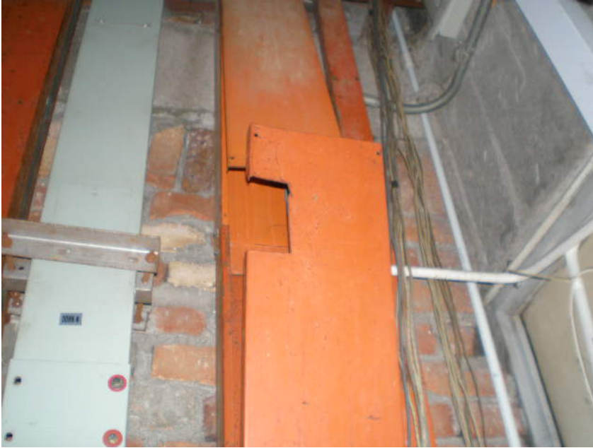
No 11 : Trunking yang telah tercabut penutup
