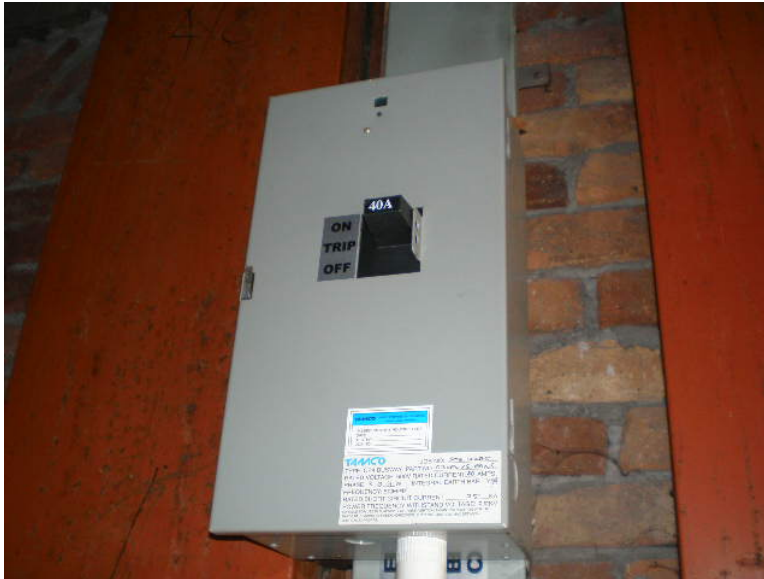
No 3 : Pengagihan bekalan tap off unit yang tidak sesuai
