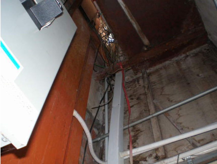
No 7 : Keadaan pendawaian di bilik riser yang tidak teratur
