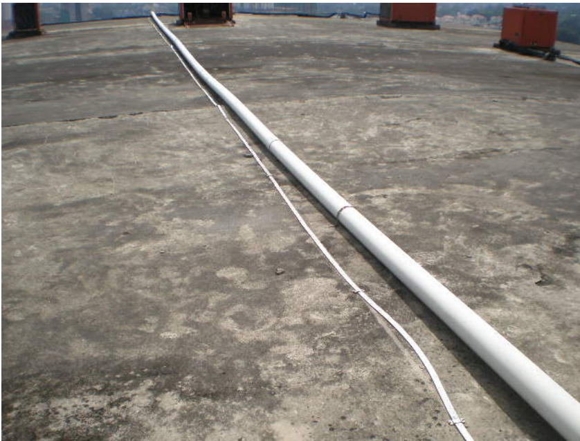
No 14 : Keadaan copper tape yang perlu di tukar kerana keberkesanan fungsinya sudah kurang
