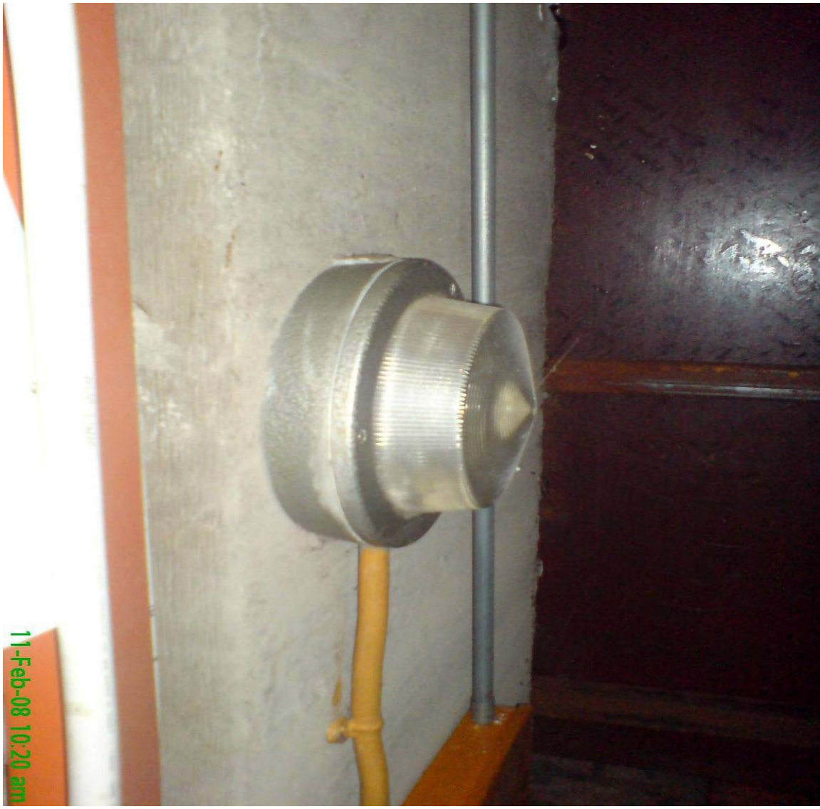
Lampu Bilik Riser tidak berfungsi
