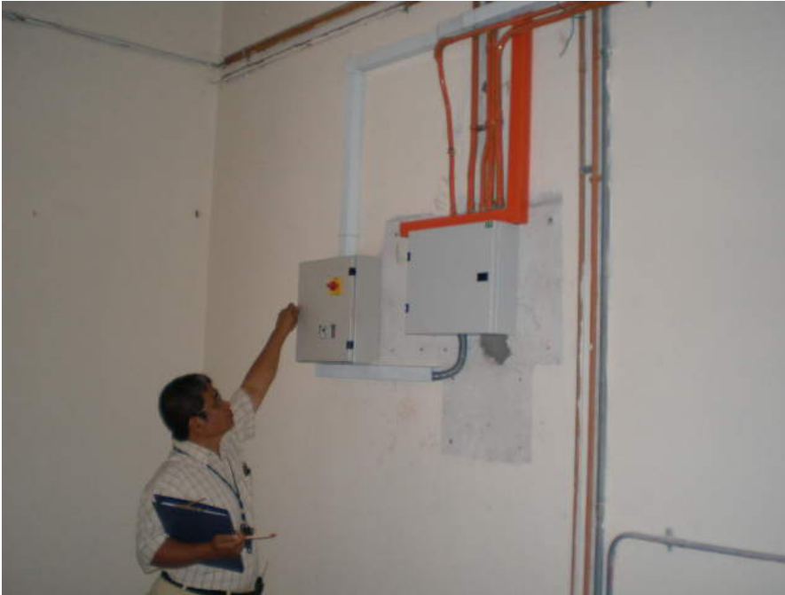
No 13 : Isolator yang terdapat dalam rumah pam
