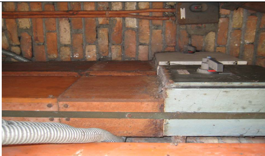
GAMBAR 16A Trunking, kotak Isolator dan Fius Suis telah berkarat.
