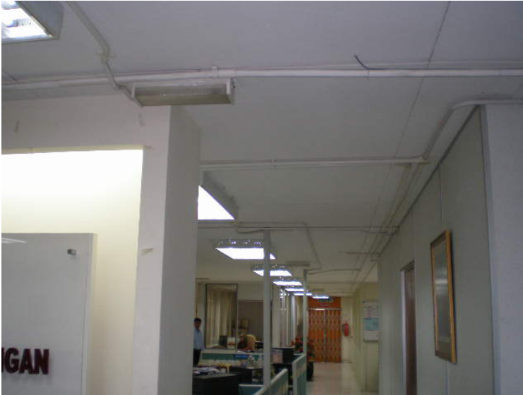
No 1 : Menggunakan pendawaian conduit permukaan.
