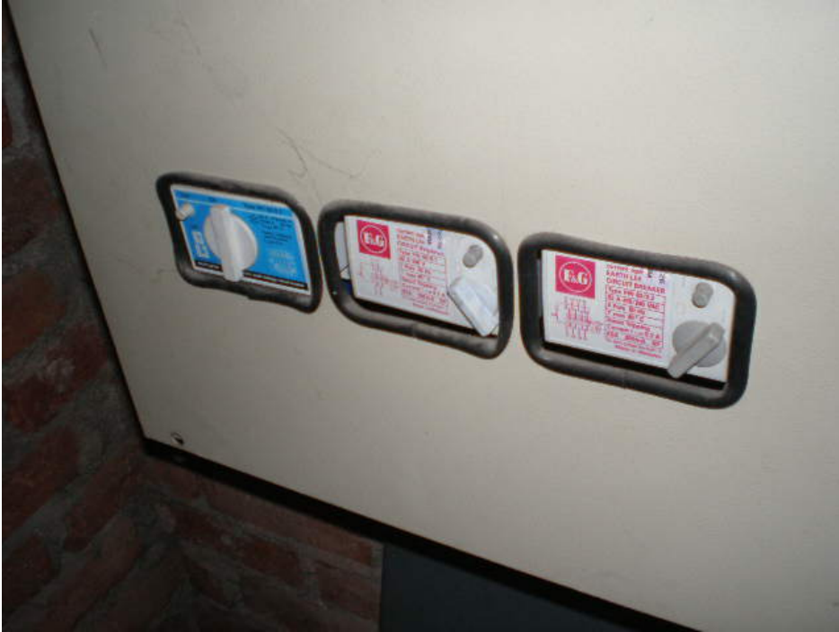
No 9 : ELCB telah di tambah kerana BD yang sediaada tidak mempunyai ELCB
