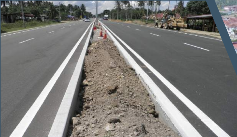
Kerja Naiktaraf Laluan FT3 Jln. Kuala Terengganu - Kuantan daripada 2 Lorong Kepada 4 Lorong Di Daerah Marang Dan Kemaman, Terengganu (Fasa 3)
