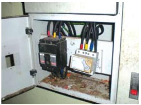
ELCB yang di ‘bypass’ menyebabkan ia tidak dapat memutuskan litar jika arus bocor ke bumi.
