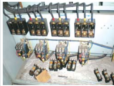
Power Factor Correction System yang tidak disenggara dengan baik. Fius-fius yang telah rosak tidak diganti baru menyebabkan sistem ini tidak dapat beroperasi sepenuhnya.
