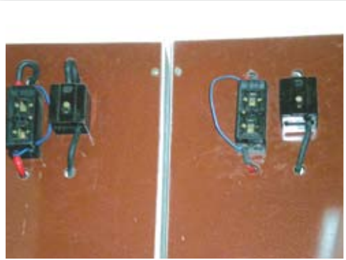
‘Cut-Out Fuse’ yang hilang tidak diganti baru, sebaliknya menggunakan kabel sebagai ‘by-pass’ kepada sistem elektrik. Tujuan ‘Cut-Out Fuse’ adalah bagi memutuskan bekalan jika terdapat arus lebih.
