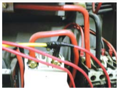
Penyambungan kabel menggunakan PVC tape. Fasa dan saiz kabel bagi penyambungan tersebut juga adalah berlainan dan boleh mengelirukan.
