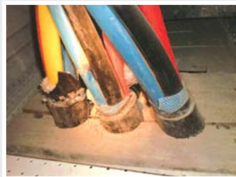
Penyambungan kabel masukan (submain) tidak menggunakan cable gland. Ini menyebabkan perisai (armour) yang juga berfungsi sebagai pembumian telah dipotong.
