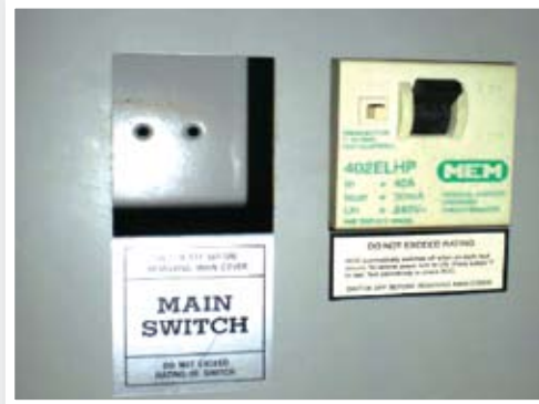
Main Switch (isolator) didapati telah hilang. Pendawaian terus disambungkan pada ELCB tanpa Main Switch.
