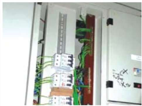
Pendawaian kabel bagi setiap fasa menggunakan kabel hijau/bumi. Pendawaian seperti ini boleh mengelirukan dan membahayakan nyawa pengendali.
