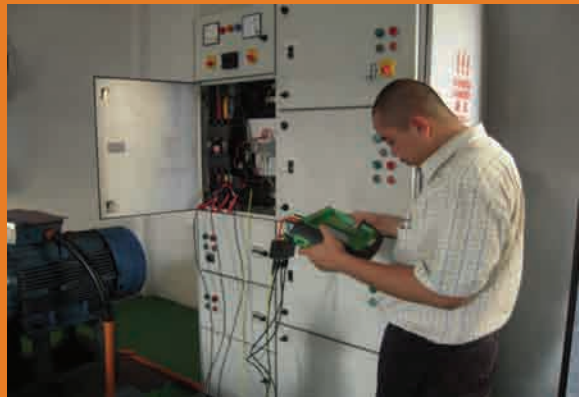
Mengambil bacaan penggunaan elektrik bagi sistem mekanikal menggunakan Power Meter Logger
