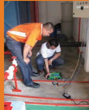
Mengambil bacaan penggunaan elektrik menggunakan Power Meter Logger
