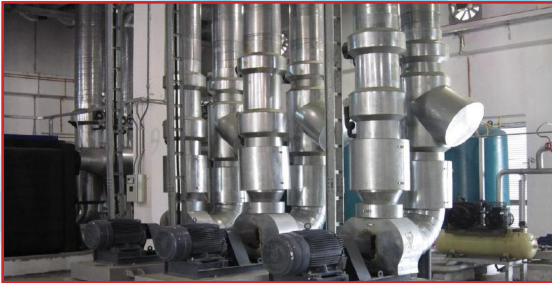
▲ Brine Chiller (Sistem Penyaman Udara Berpusat)
