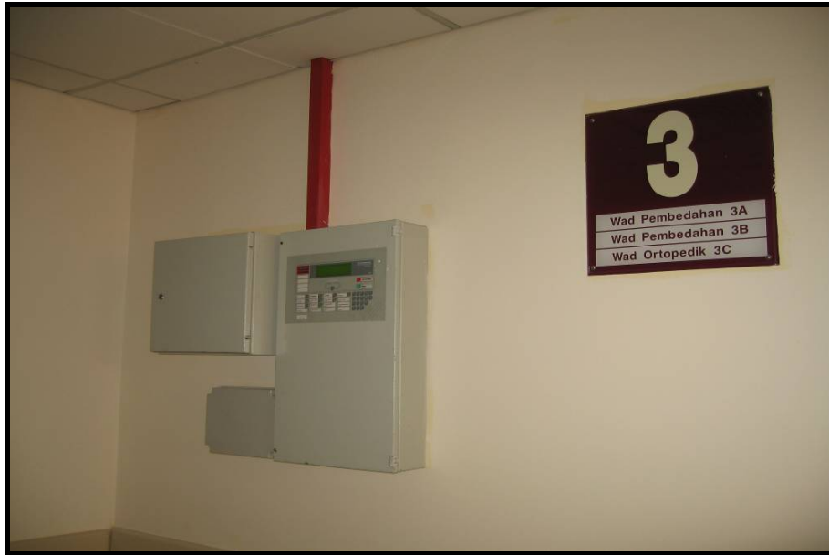
Gambar 1 : Sub-Fire Alarm Panel (SFAP) di tingkat 3
