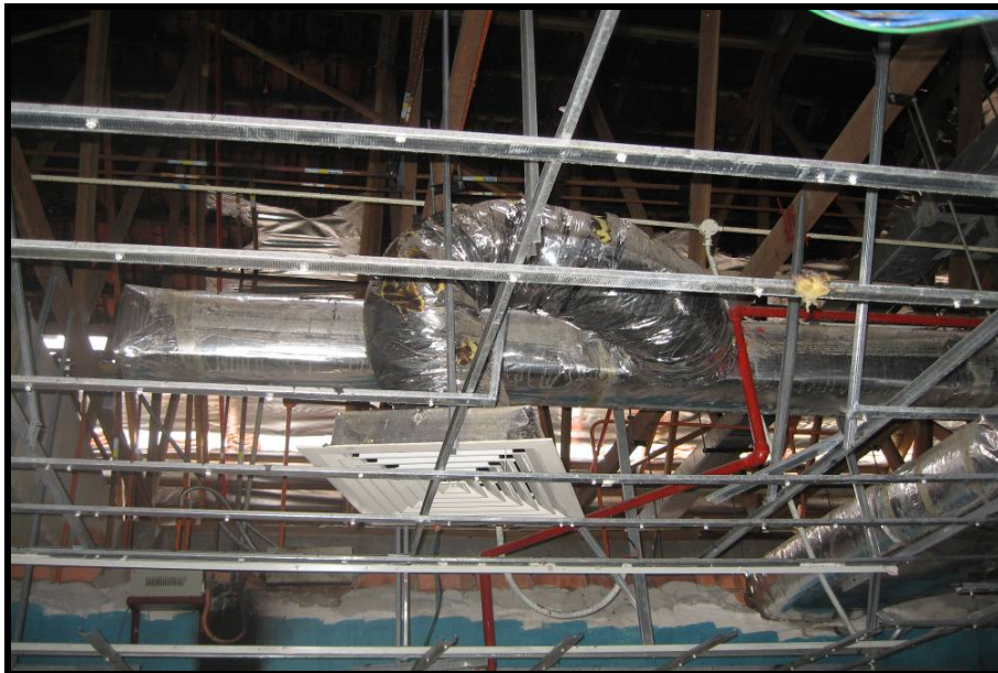
Gambar 4 Sesalur (Duct) yang terbakar
