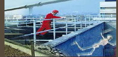
Edge Protection railings
