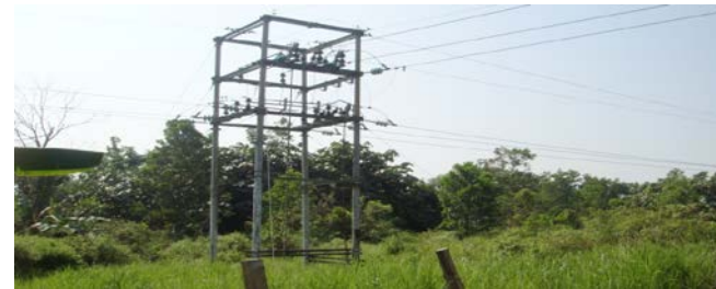
KABEL ELEKTRIK YANG TERDAPAT SEPANJANG JAJARAN BARU
