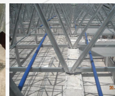
Pertengahan rentang kekuda bumbung tidak disokong (intermediate support)
