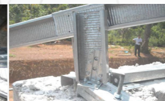
Pemasangan heel support yang tidak pugak pada anggota top chord kekuda dan pemasangan anchor bolt yang tidak ketat dan kedalaman (embedment length) ke dalam rasuk bumbung
