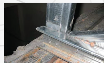
L-Bracket dipasang diantara anggota. Tidak mematuhi keperluan rekabentuk; panjang thread skrew tidak mencukupi
