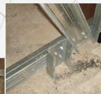
Sokong kekuda tidak selaras dengan lukisan pembinaan dimana L-Bracket dan anchor bolt tidak dipasang
