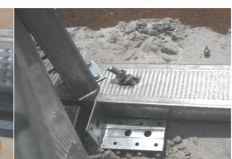
Pemasangan anchor bolt yang tidak kemas dan tidak mengikut amalan kejuruteraan yang baik
