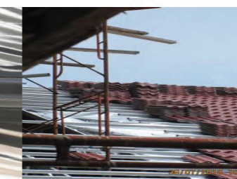
Pengagihan beban atap genting di atas struktur kekuda bumbung pada satu kawasan (tile perlu diletakkan secara seragam)
