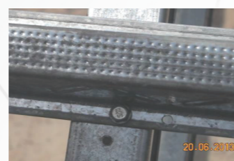
Pemasangan fastener batten yang tidak mencukupi
