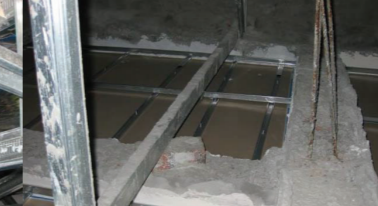
Tambahan sokongan yang tidak rekabentuk
