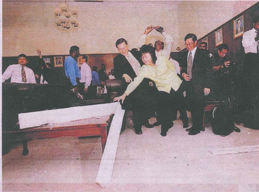
BEKAS DUN Jawi, Tan Cheng Liang (tengah) melihat plaster siling yang terjatuh di Bangunan Dewan Undangan Negeri Pulau Pinang semalam.
