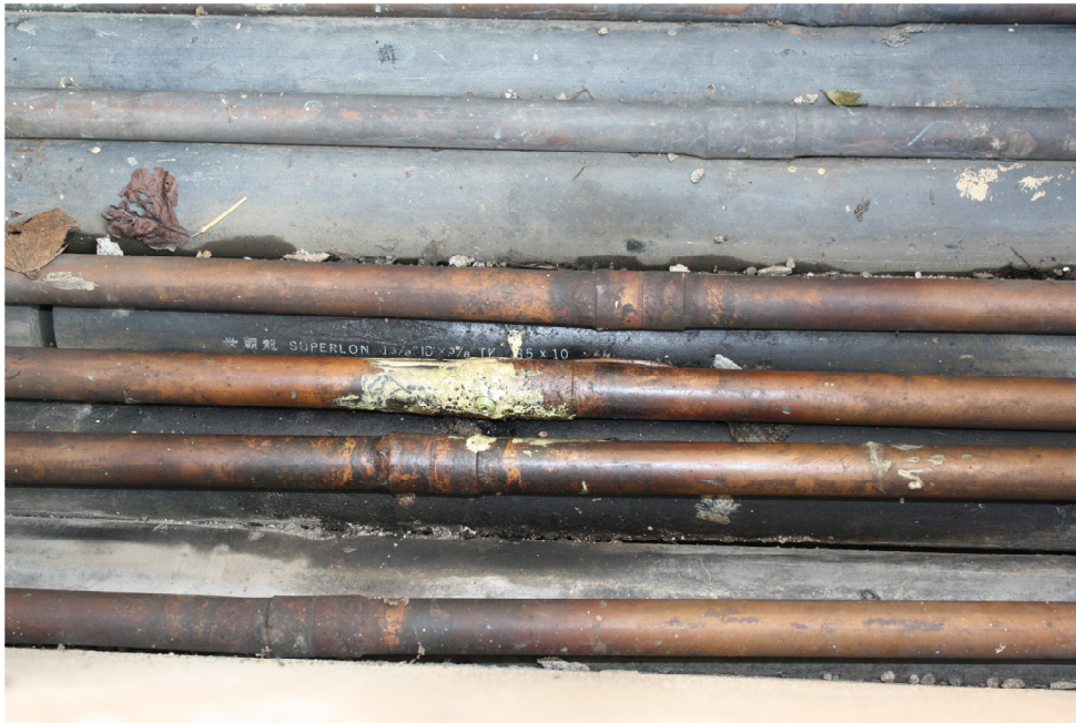
Gambar 5: Paip refrigerant kelihatan bocor pada laluan terowong
