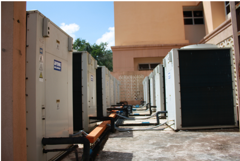
Gambar 6: Pemasangan paip refrigerant didalam bilik outdoor tanpa menggunakan casing .
