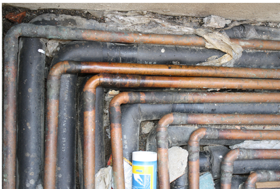
Gambar 4: Paip refrigerant kelihatan bocor pada laluan terowong
