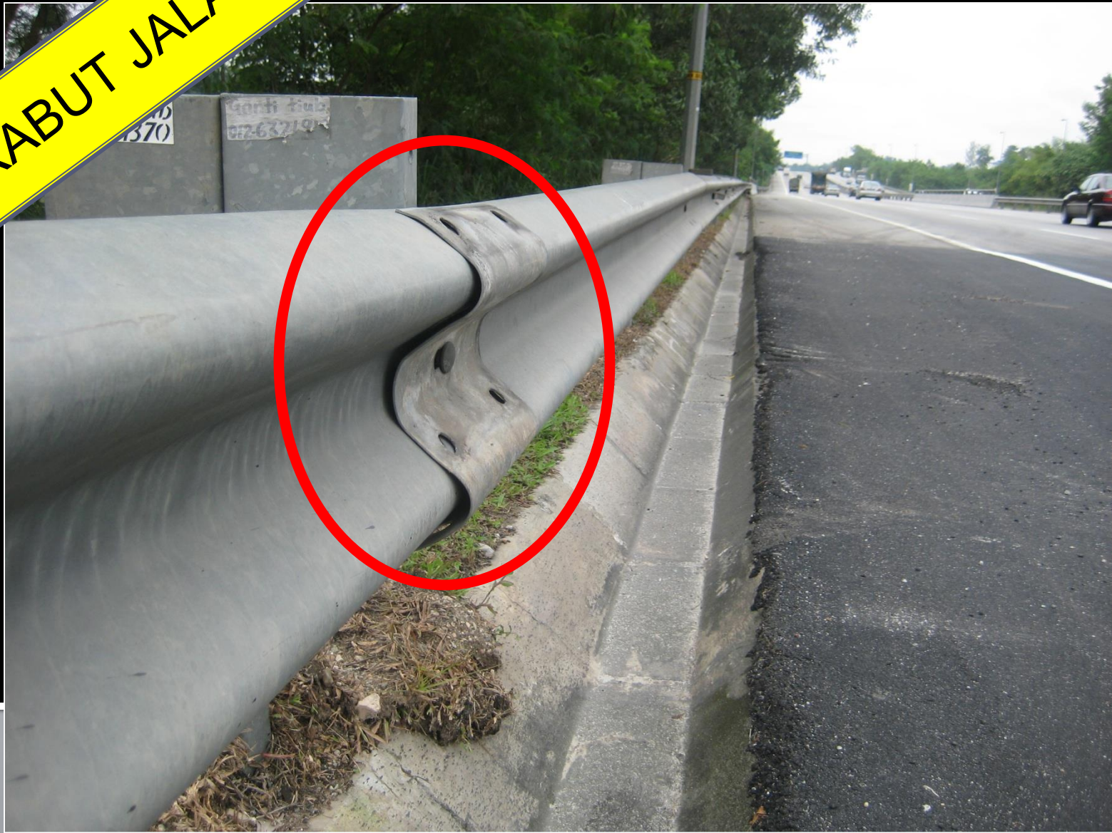
Pemasangan guardrail silap
