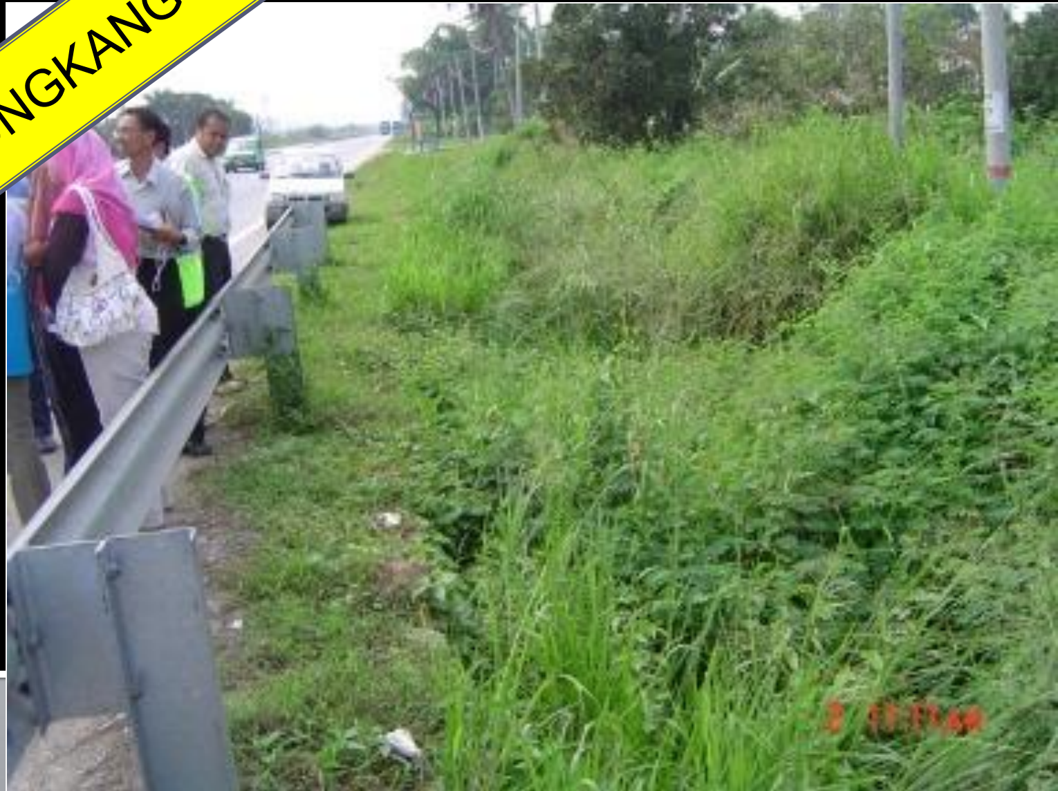
Longkang tidak disenggara. Rumput tumbuh meliar
