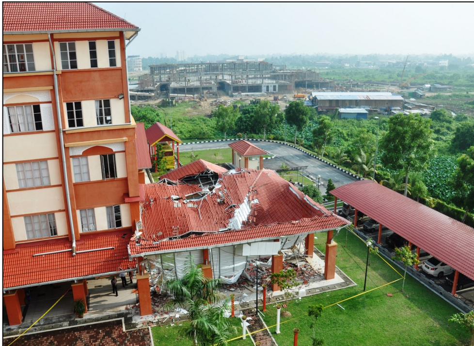
Keruntuhan bumbung di kantin : Pandangan dari atas
