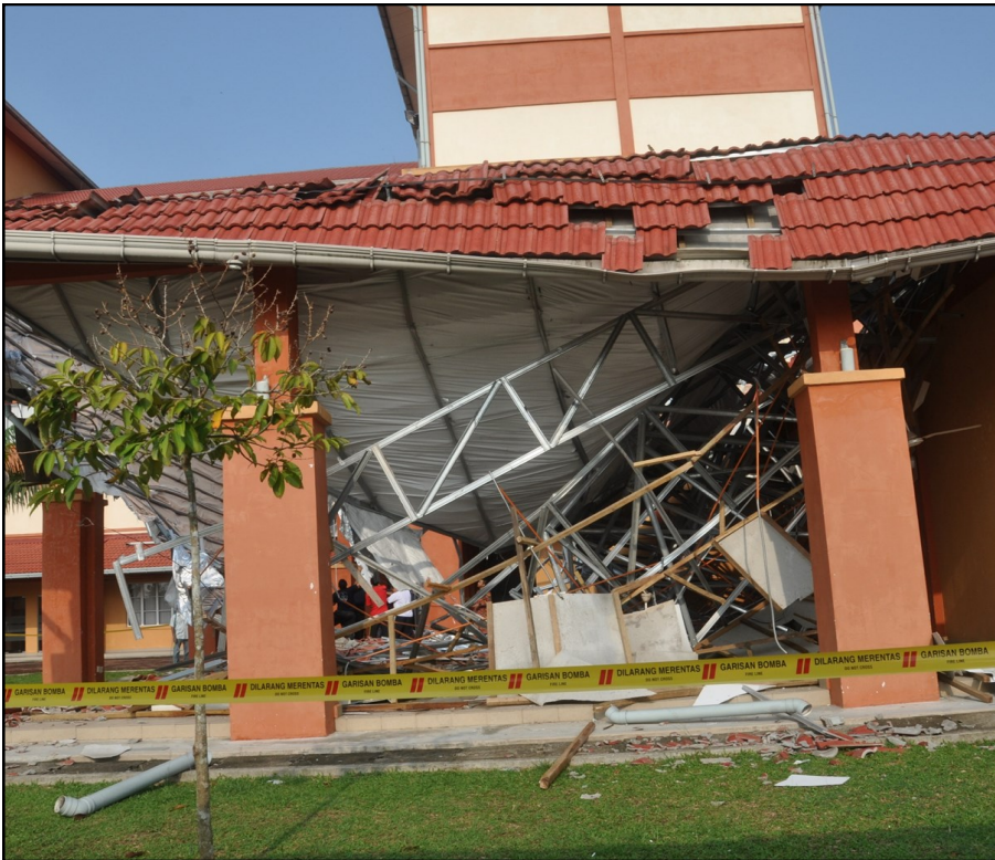
Keruntuhan bumbung di kantin: Pandangan hadapan
