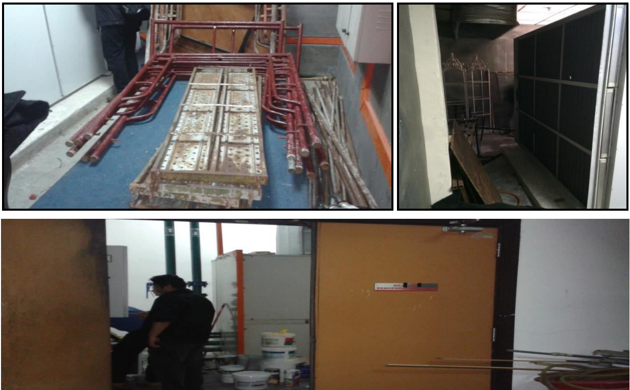
Gambar menunjukkan keadaan bilik AHU yang dijadikan tempat simpanan barang.
