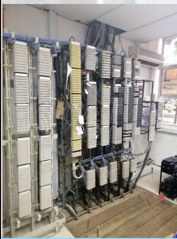
Keadaan bilik Subscriber Distribution Frame (SDF) yang masih menggunakan kabel jenis Multipair (Copper Cable) untuk sistem telefon
