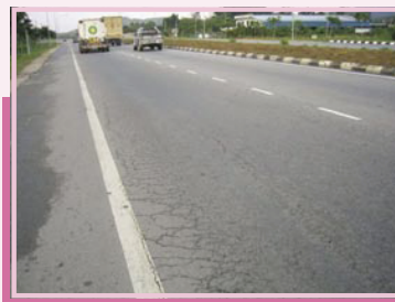
Permukaan jalan kering mungkin disebabkan kekurangan bitumen yang boleh menyebabkan keretakan pra-matang.
