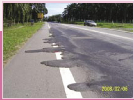
Permukaan jalan yang berubah bentuk.
