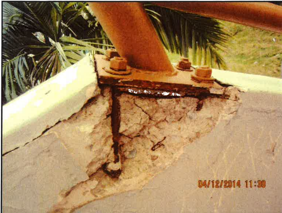
Gambar 16: Konkrit pecah sehingga anchor bolt base plate terdedah
