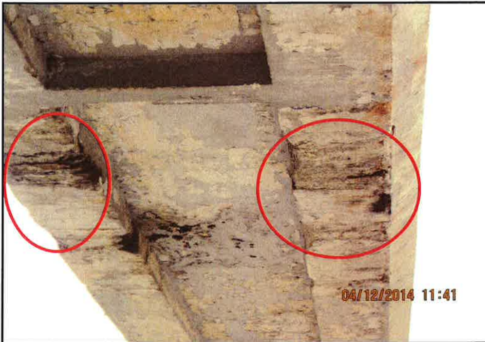
Gambar 9: Spalling pada bahagian soffit beam serta tetulang berkarat dan terdedah akibat pelanggaran kenderaan berat serta cat mengelupas di seluruh struktur main crossing
