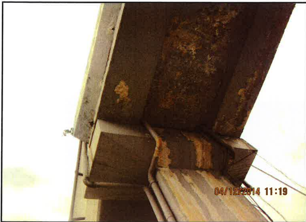
Gambar 20: Kebocoran Pada PWDP kesan lelehan air pada soffit slab, beam dan pier serta cat mengelupas
