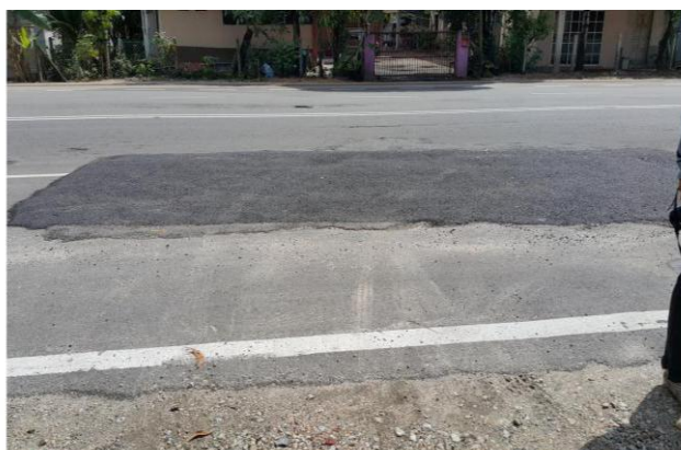
GAMBAR 3 : Patching tidak sempurna
