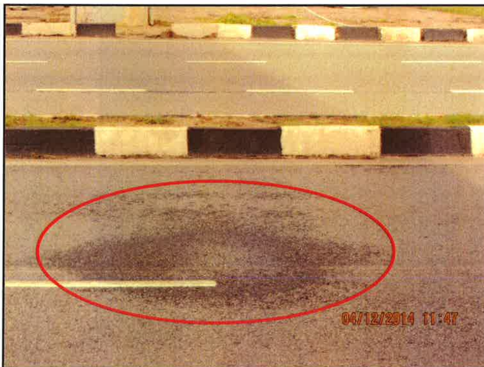
Gambar 12 : Kesan resapan dan lelehan air dari deck slab menitik ke jalanraya
