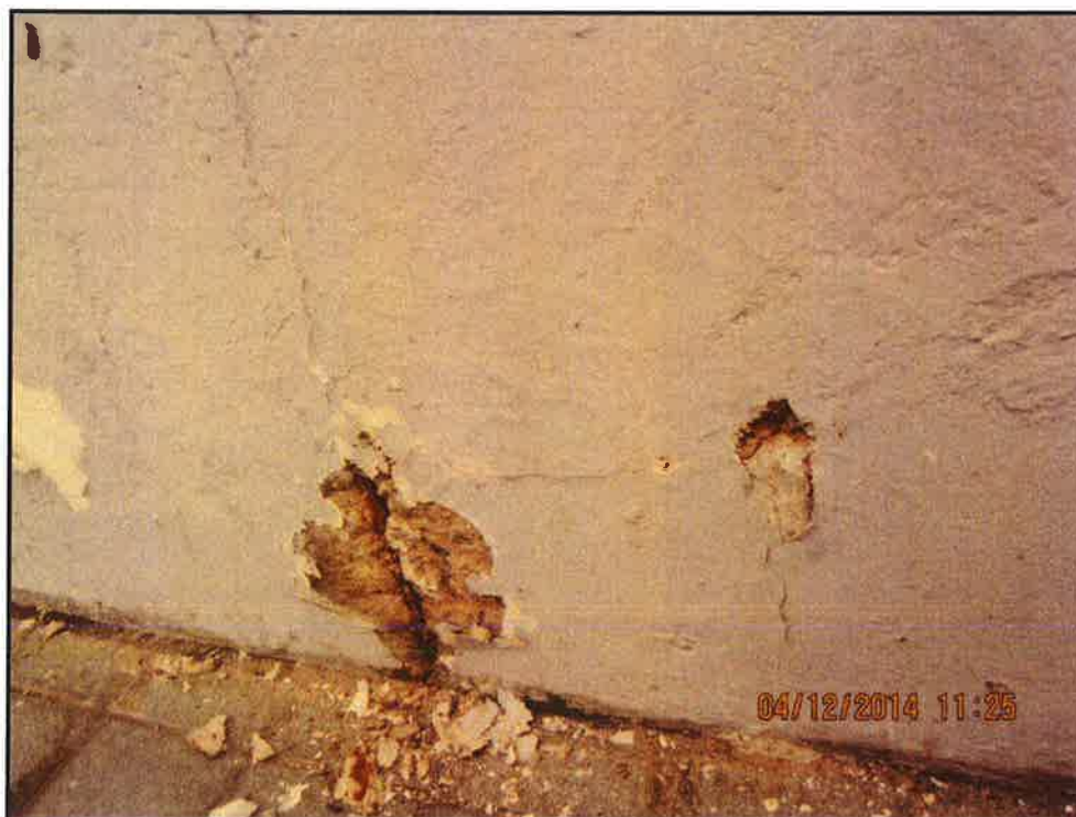
Gambar 15: Terdapat besi terdedah dan berkarat serta konkrit porous pada parapet wall
