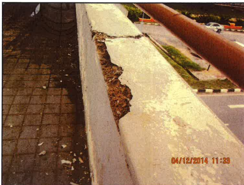
Gambar 14: Terdapat konkrit porous pada parapet wall
