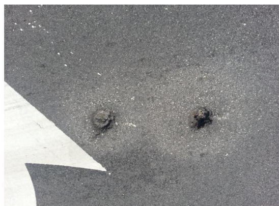
GAMBAR 4 : Pothole atas permukaan pavemen
