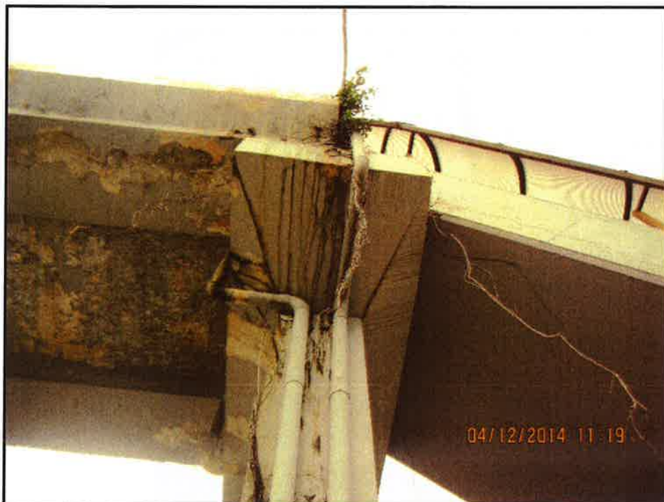
Gambar 21: Kebocoran Pada PWDP kesan lelehan air pada soffit slab, beam dan pier serta cat mengelupas dan terdapat tumbuhan
