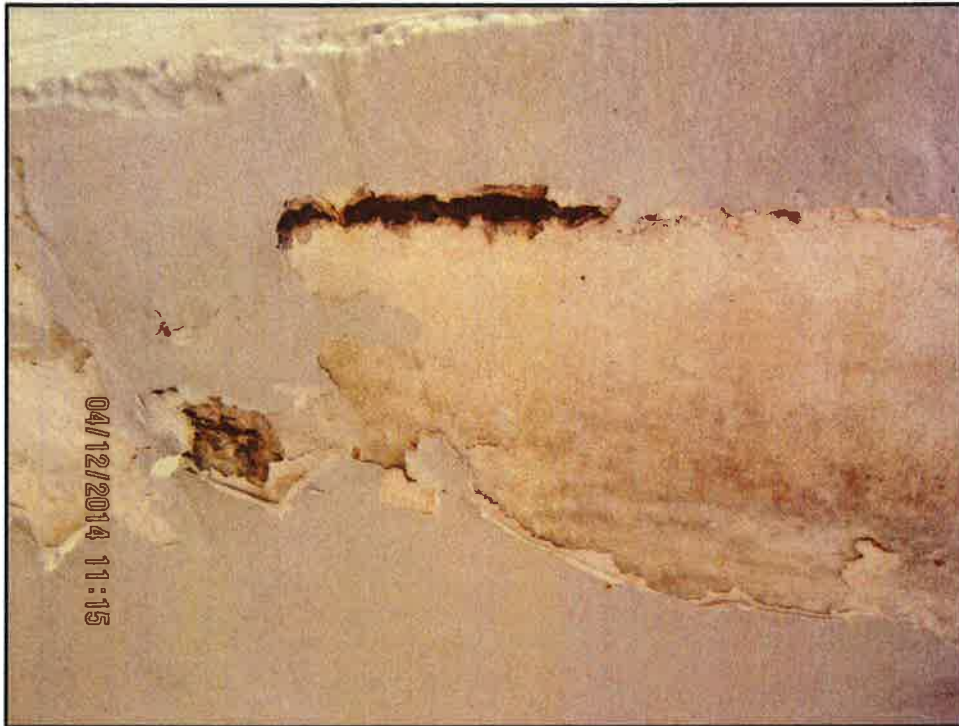
Gambar 4: Pengaratan tetulang akibat penutup konkrit tidak mencukupi dan cat mengelupas di bahagian bawah tangga
