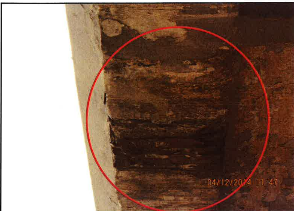
Gambar 10: Spalling pada bahagian soffit beam serta tetulang berkarat dan terdedah akibat pelanggaran kenderaan berat
