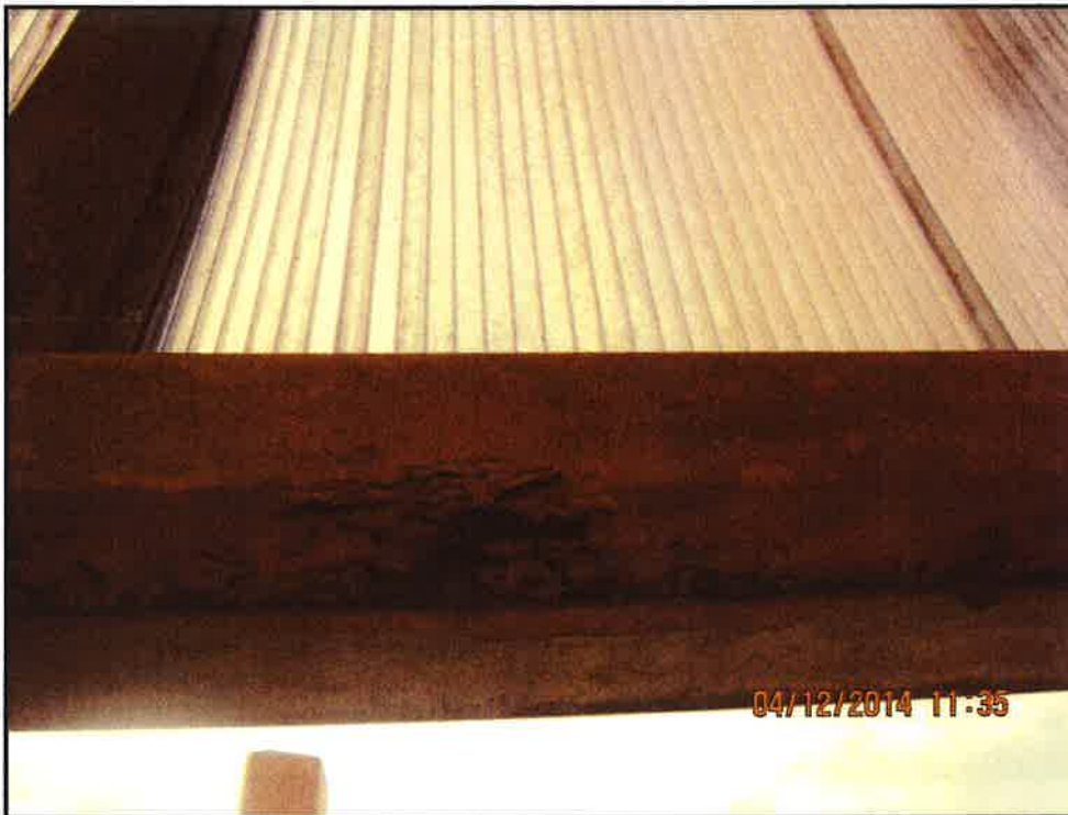
Gambar 22: Terdapat pengkaratan besi di kebanyakan frame bumbung jejantas
