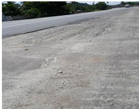
GAMBAR 2 : Tiada tindakan pembaikan pavemen di lakukan
