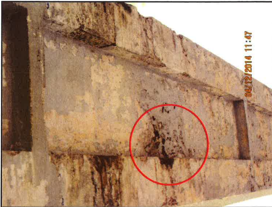
Gambar 11: Kesan resapan dan lelehan air dari deck slab menitik ke jalanraya
