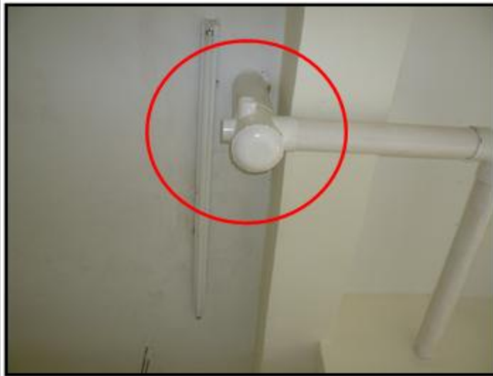
Gambar 24: Pemasangan Lampu Berdekatan Paip Sanitari Di Stor Aras Bawah Kuarters G
