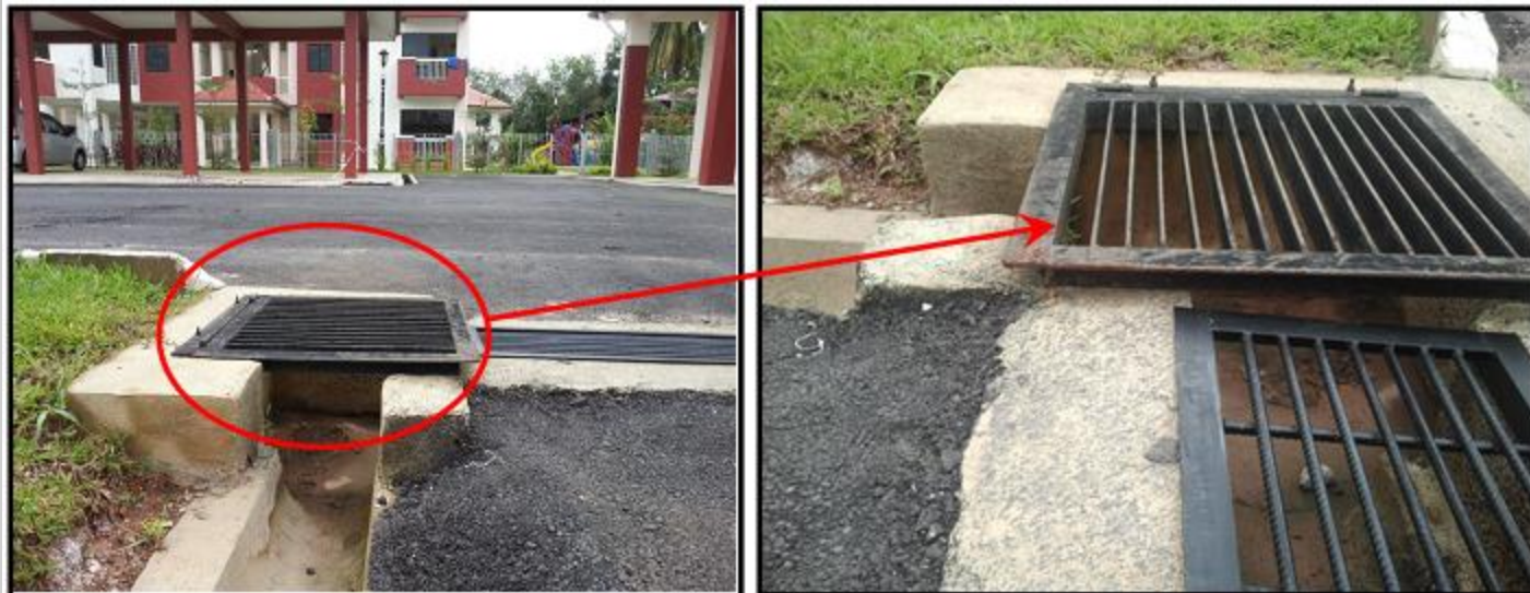
Gambar 10: Grating Tidak Sesuai Dengan Sump
