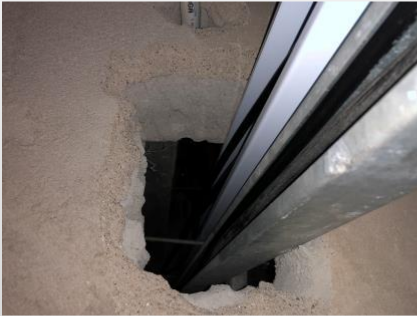
Laluan Conduit Tidak Ditutup Dengan Sempurna
