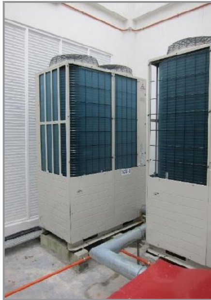
Sistem Penyejukan Udara dan Pengudaraan Mekanikal (ACMV)
