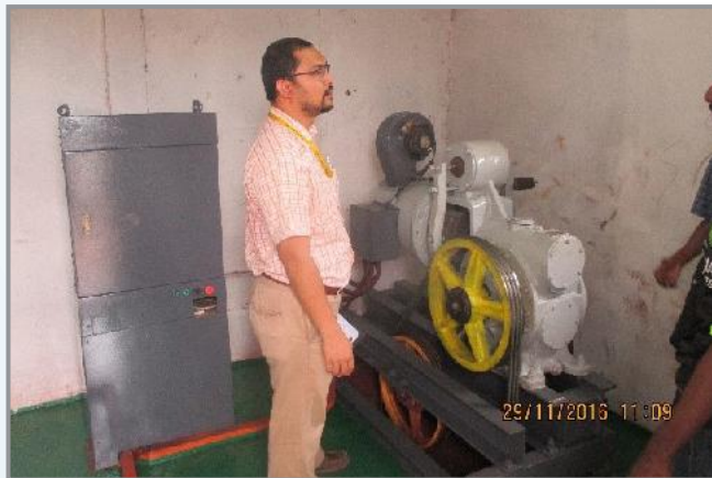
Pemeriksaan peralatan lif di dalam Lift Motor Room di Kompleks Kerja Raya
