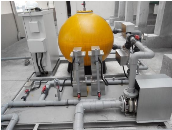
Rajah 18: Contoh side stream filtration yang dipasang pada menara penyejuk di Universiti Monash, Bandar Sunway
