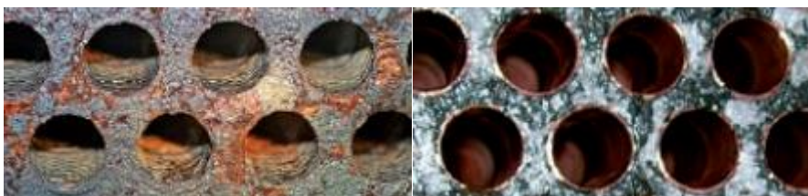
Rajah 26: Perbezaan permukaan tiub kondenser sebelum dibersihkan (kiri) dan selepas dibersihkan (kanan)
