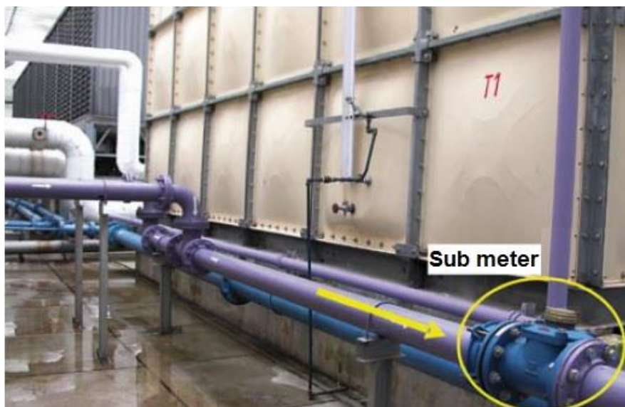
Rajah 8: Contoh sub meter yang dipasang pada make up water tank ke menara penyejuk
