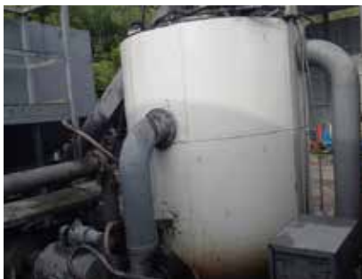
Tangki pembancuh dilengkapi dengan motorised stirrer di mana bitumen dibancuh dengan crumb rubber.
