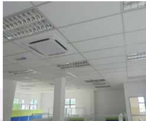
Fan Coil Unit Di Ruang Pejabat
