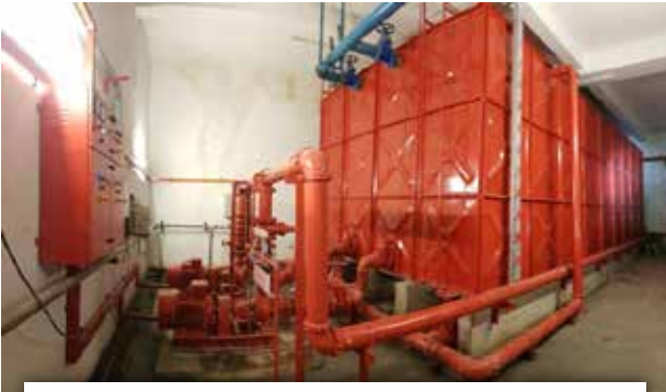
Tangki Air, Pam Dan Panel Kawalan Untuk Sistem Automatic Sprinkler
