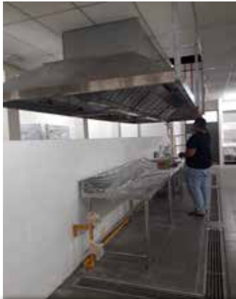
Sistem Kitchen Hood Di Blok Dewan Makan
