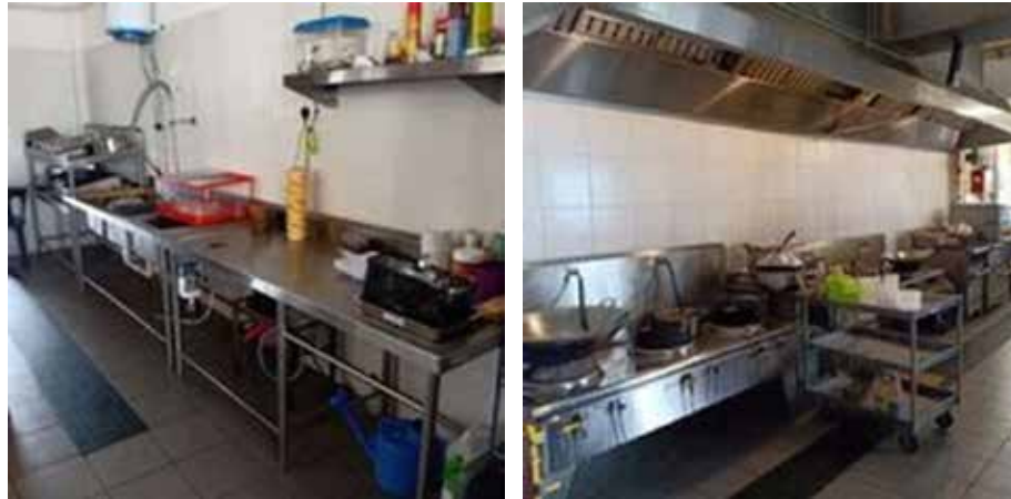
Kitchen Hood Lengkap Dengan Sistem Wet Chemical Dan Peralatan Dapur Di Kafeteria
