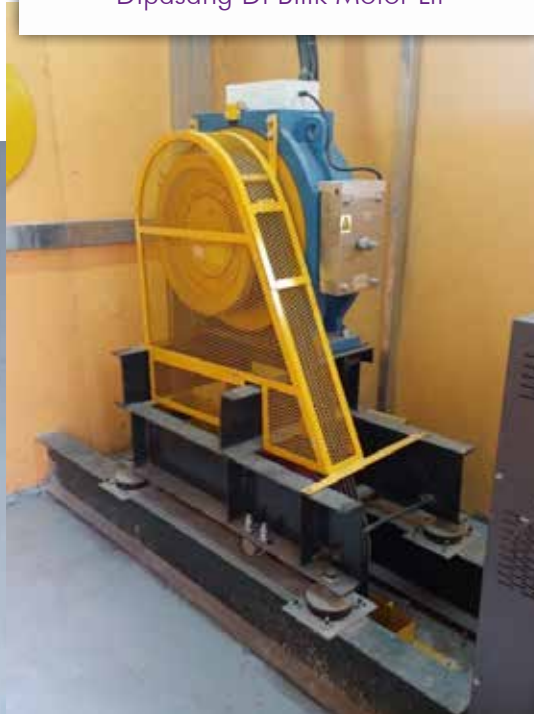
Traction Machine Yang Telah Siap Dipasang Di Bilik Motor Lif
