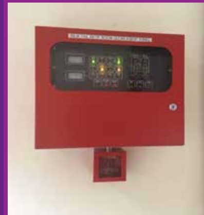
Panel Kawalan Clean Agent (FM200) Di Bilik Fail Aktif
