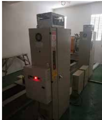
Panel Kawalan Motor Di Bilik Motor Lif
