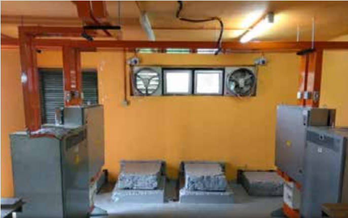
Lift Controller Baru Yang Telah Siap Dipasang Di Dalam Bilik Motor Lif
