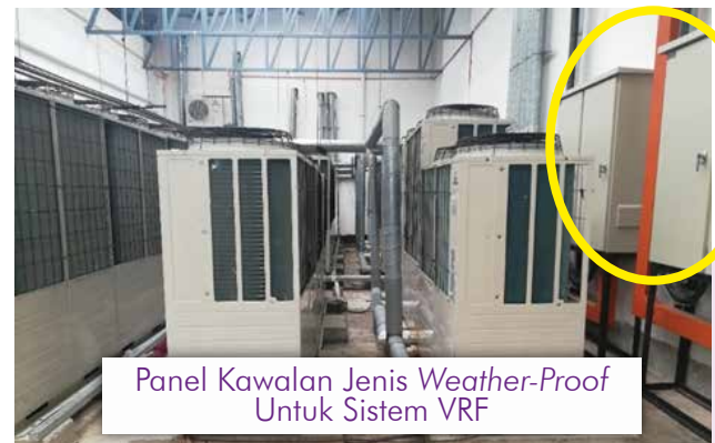
Outdoor Unit Sistem VRF Di Aras Bumbung
