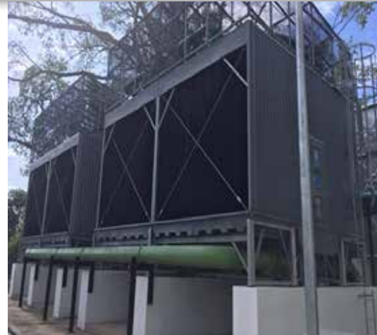
Jaring Dipasang Di Bahagian Atas Cooling Tower Bagi Mengelakkan Kemasukan Bendasing
