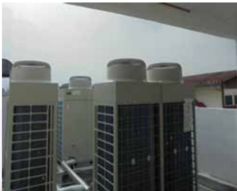
Sistem Penyaman Udara Jenis Variable refrigerant flow (VRF) Inverter
