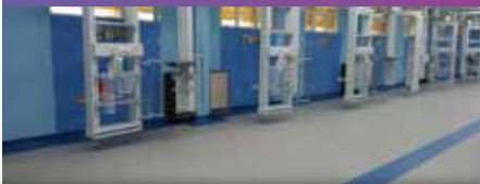
Sistem Gas Perubatan Yang Menggunakan Single Arm Double Pendant, Water Inlet Dan Outlet Bagi Portable R.O Bagi Setiap Katil
