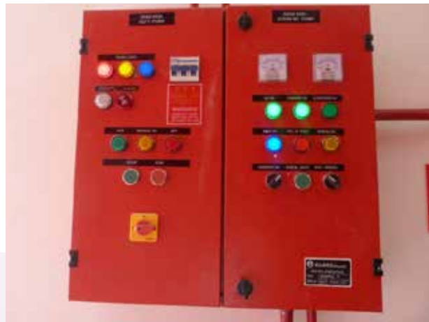
Peralatan Sistem Pencegah Kebakaran
