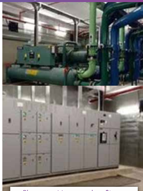
Plantroom Menempatkan Sistem Water Cooled Chiller
