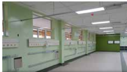
Sistem Gas Perubatan Yang Menggunakan Double Tier Bedhead Panel
