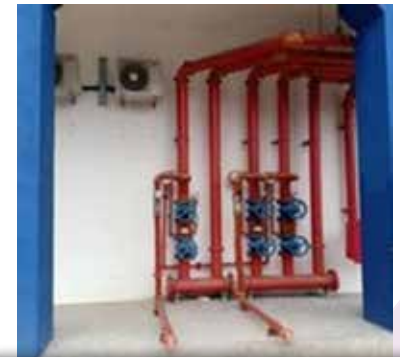
Alarm Valve Diletakkan Di Kawasan Yang Mudah Diakses Oleh Pihak Bomba
