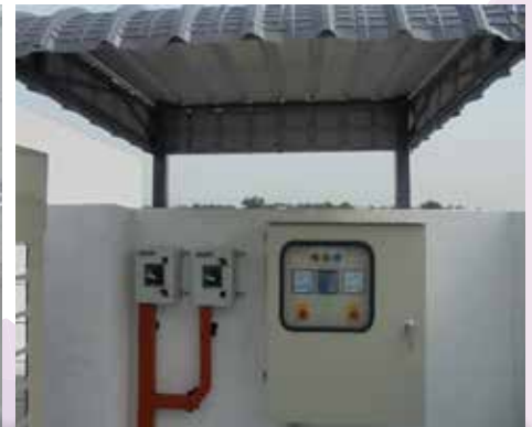
Panel Kawalan Bagi Sistem Penyaman Udara
