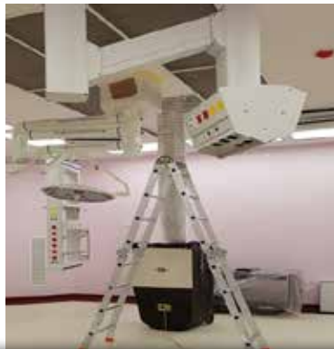
Sesi Pengujian Sistem Penyaman Udara Di Dewan Bedah
