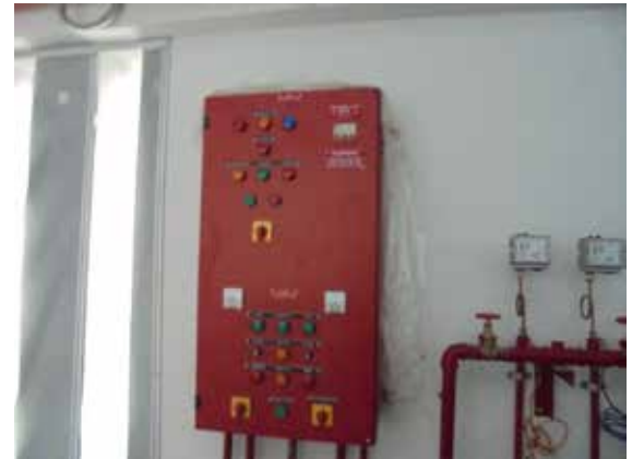
Panel Kawalan Bagi Sistem Pencegah Kebakaran
