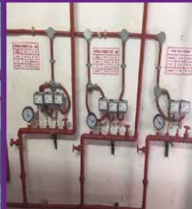
Pump Start Test Pipe Dan Pressure Gauge Untuk Sistem Automatic Sprinkler Dan Sistem Hose Reel
