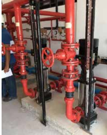
Pam Wet Riser Dan Hose Reel Yang Terletak Di Dalam Bangunan Mekanikal
