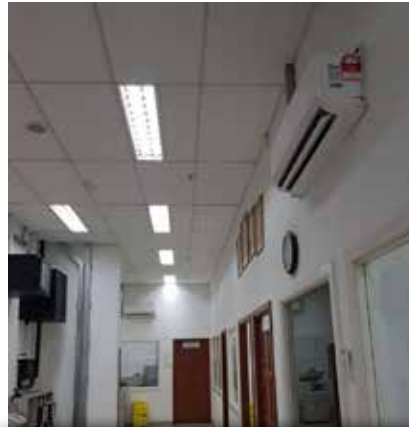
Fan Coil Unit Di Ruang Pejabat
