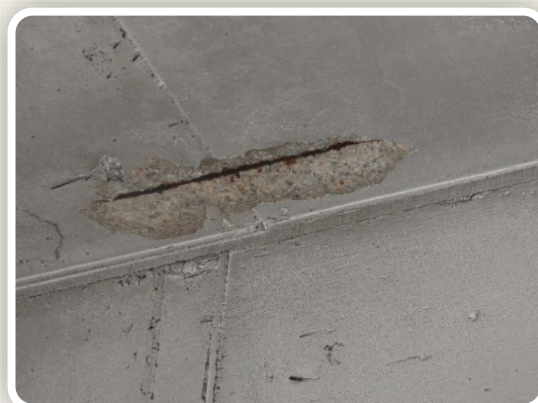
Terdapat pengelupasan pada penutup ( cover ) soffit papak bumbung rata di dalam Bilik Motor Lif di bangunan Pentadbiran IPK Kuala Lumpur.
