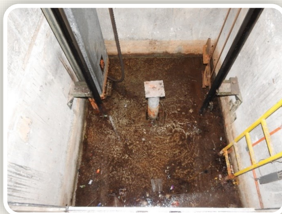
Terdapat takungan air di dalam lift pit di bangunan perumahan Balai Polis Pantai Remis, Perak.
