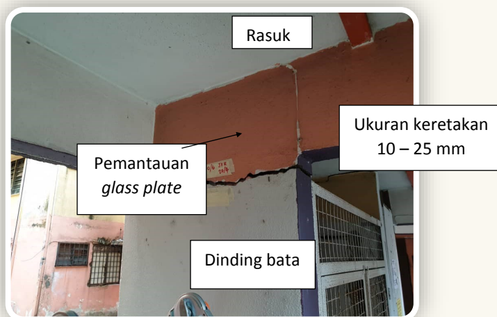
Gambar 5 : Keretakan antara muka dinding bata dengan rasuk di Aras Bawah
