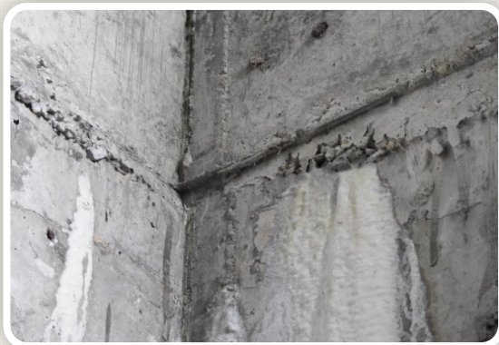
Kecacatan konkrit honeycomb dan efflorescence pada dinding lif core di bangunan perumahan Balai Polis Pantai Remis, Perak.
