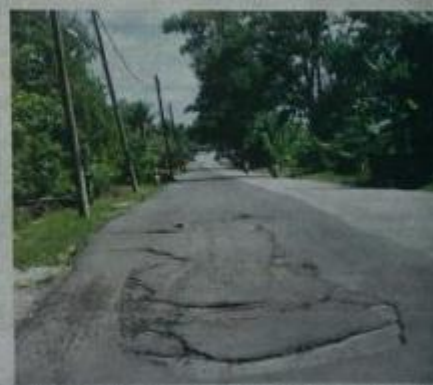
Jalan rosak di sekitar Temangan kembali menimbulkan kekecewaan kepada pengguna dan penduduk, semalam.
