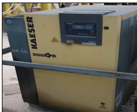
Rajah 3.1.9.1 : Air Compressor
