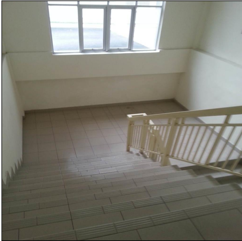
Gambar 9.4 : Tangga di tempat letak kereta
