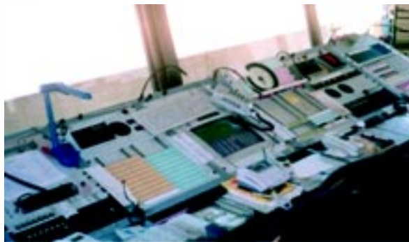
Sistem Kawalan Trafik Udara Di Lapangan Terbang Kertih
